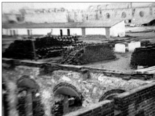
Fig. 2: Universidad Laboral de Zamora. Vista interior de los muros resistentes del ala de externos.
