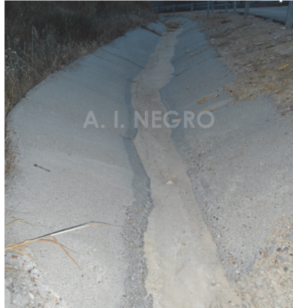
Figura 2. Cuneta hacia donde drena la escorrentía de los taludes y plataforma de una carretera. Parte de las arenas han quedado depositadas en la cuneta, pero los materiales más finos terminan en los arroyos próximos.
