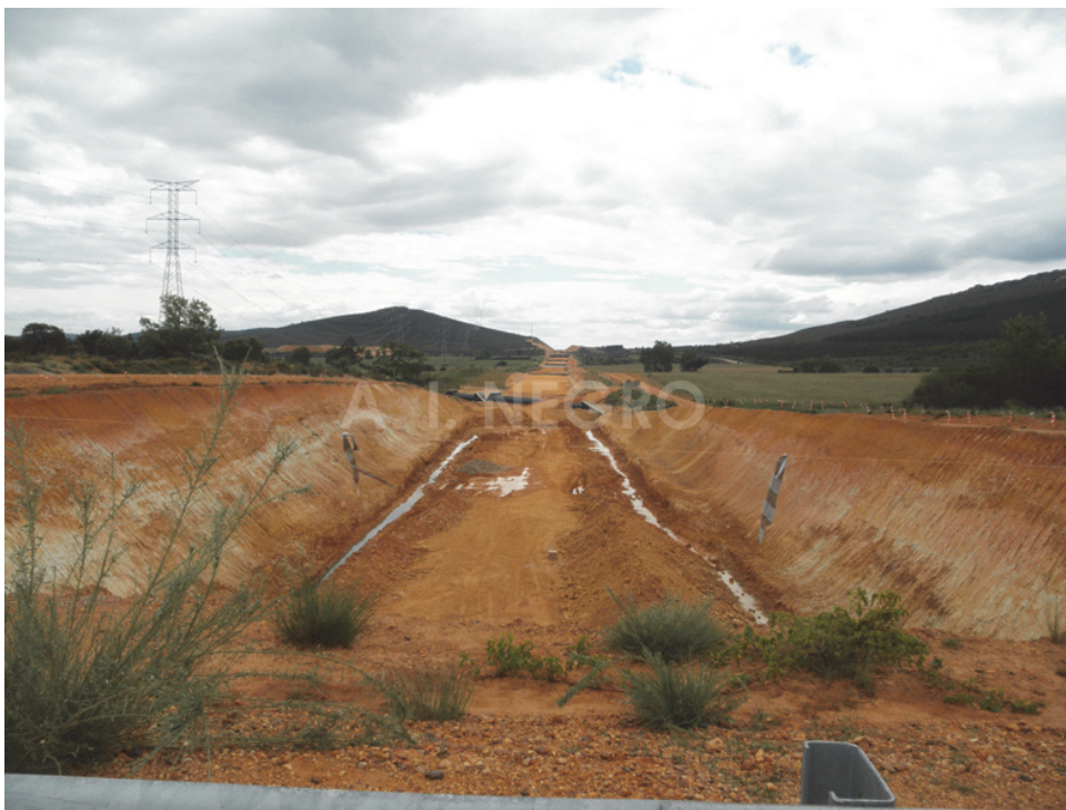
Figura 1. Corredor de la línea de ferrocarril de alta velocidad Madrid-Galicia, tramo próximo a la localidad de Litos (Zamora), actualmente en construcción. Se observa la gran superficie de suelo y vegetación que se ha eliminado para construir la trinchera.
