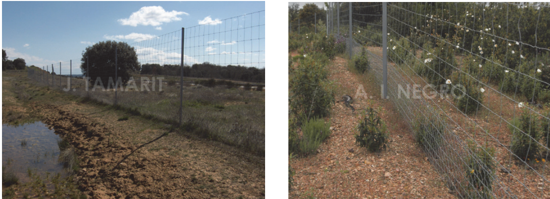
Figura 4. Vallado en la Autovía A-66. A la derecha se observa en detalle cómo la luz de la malla es más pequeña en la parte inferior para evitar el paso de animales de pequeño tamaño.
