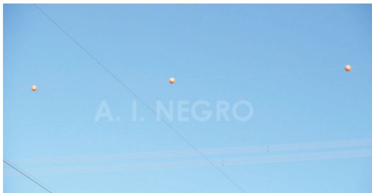
Figura 25. Dispositivos esféricos utilizados frecuentemente en los cables de las líneas de alta tensión para aumentar su visibilidad y que puedan ser sorteados por las aves.
