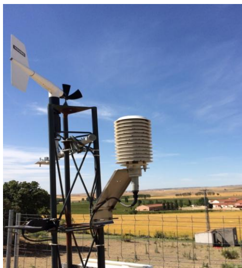
Figura 26. Estación meteorológica automática.
