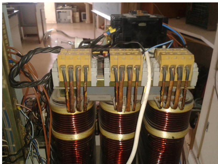
Ilustración 81 - Transformador trifásico. Detalle salida secundario.
