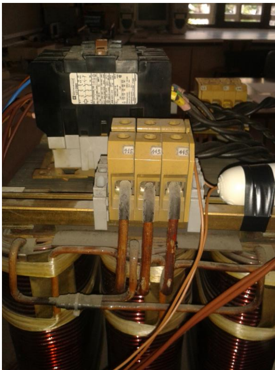
Ilustración 80 - Transformador trifásico. Detalle entrada primario.
