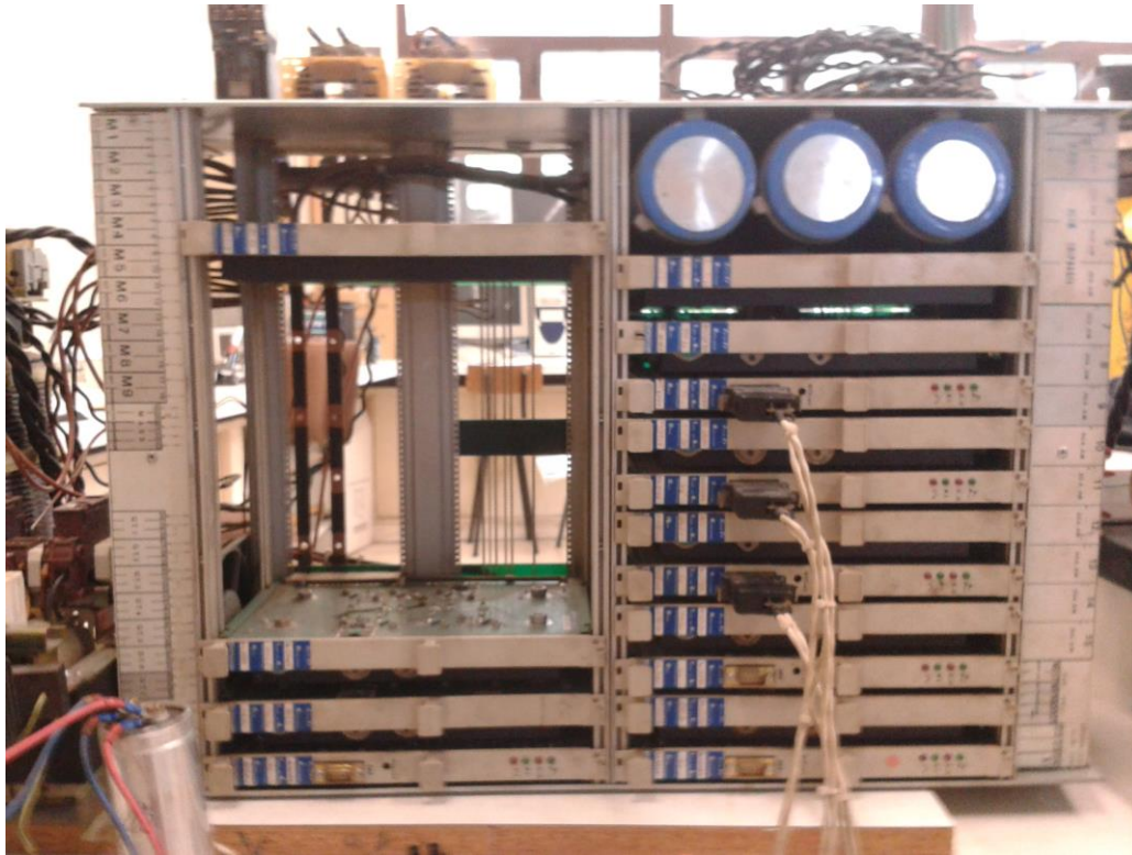
Ilustración 90 - Armario de control.
