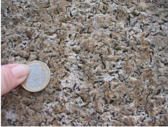
Figura 1.14. Detalle del ensuciamiento de una dovela de vaugnerita biotítica perteneciente a la fábrica moderna del Puente Romano.
