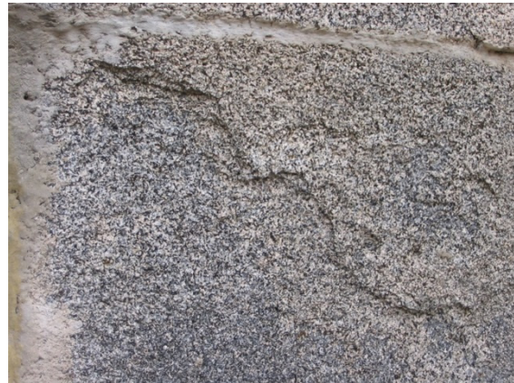
Figura 1.11. Desplacación en vaugnerita en la Portada de la Catedral Vieja.
