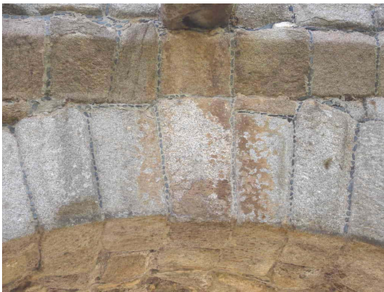
Figura 1.16. Patina en las dovelas de un arco de la fábrica romana, bajo un desagüe. Puente Romano.
