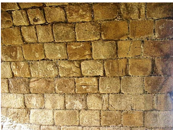
Figura 1.12. Grietas en los bloques graníticos en el intradós de un arco de la fábrica romana del Puente Romano
