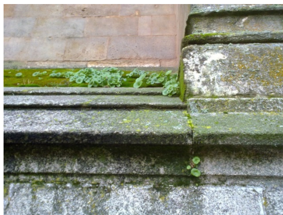
Figura 1.18. Biodeterioro en losas de granito de Los Santos junto a la Portada de Los Ramos de la Catedral Nueva
