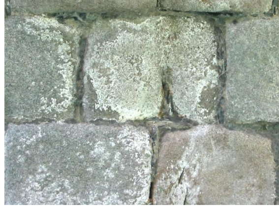
Figura 1.15. Eflorescencias salinas en rocas graníticas en el interior de un arco del Puente Romano
