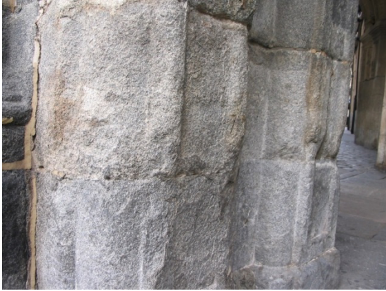
Figura 1.8. Pérdida de materia hasta desgastar la forma original, en una de las columnas del Ayuntamiento de la Plaza Mayor, construida en vaugnerita de grano fino.
