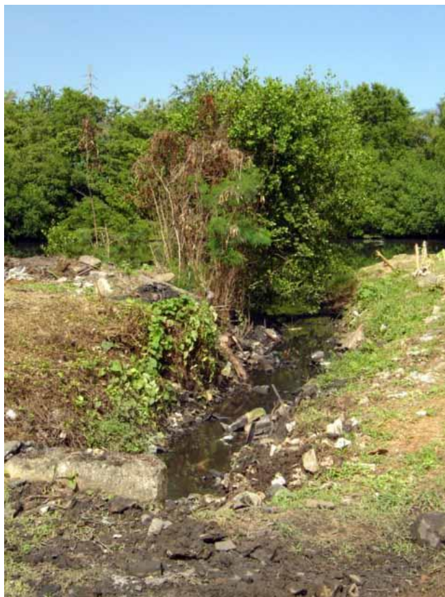
Ilustración 7.1. Desagüe y basura acumulada en el caño. Foto de la autora.
