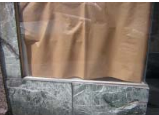
Fig. 5.- a) Deterioro de placa de serpentinita en revestimiento vertical de un local comercial en Viena.
