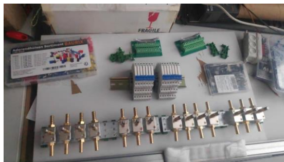
Figura 19. Rack de electroválvulas antes de instalación
