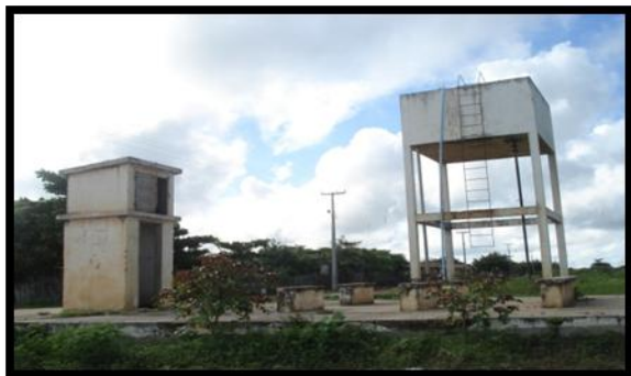
Foto nº 48– Assentamento Hipólito. Problema na distribuição de água.
