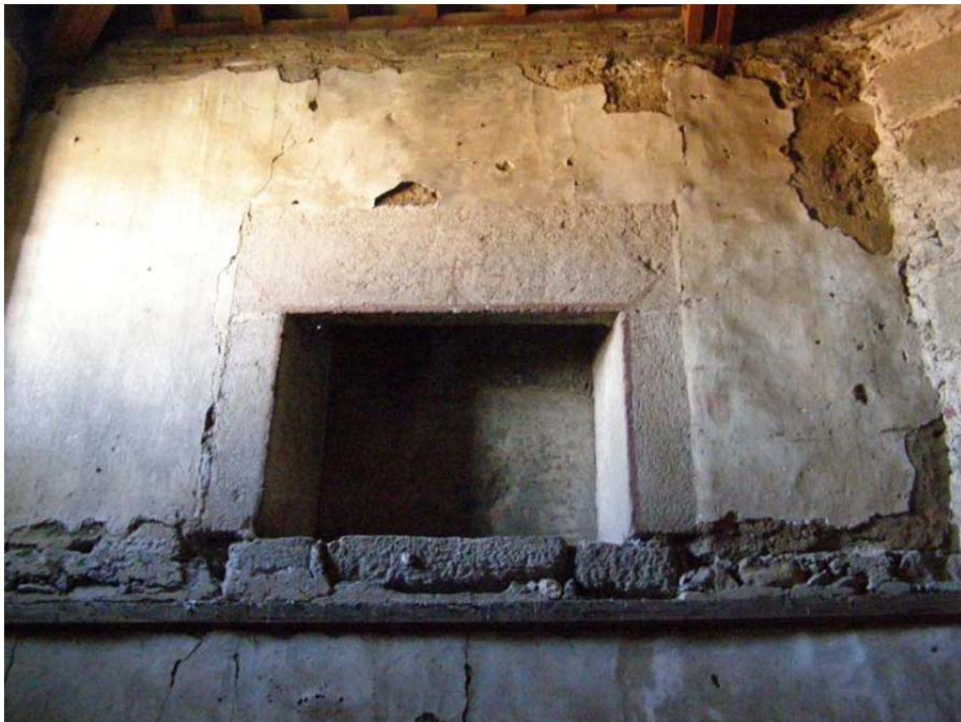
5.48. Chimenea del cuerpo arruinado de la torre
