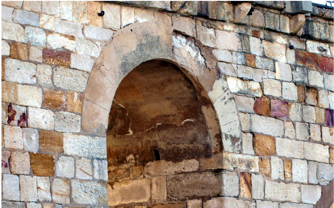
16: Vista desde aguas abajo del aliviadero de la pila 14, con detalle de mechnal.
