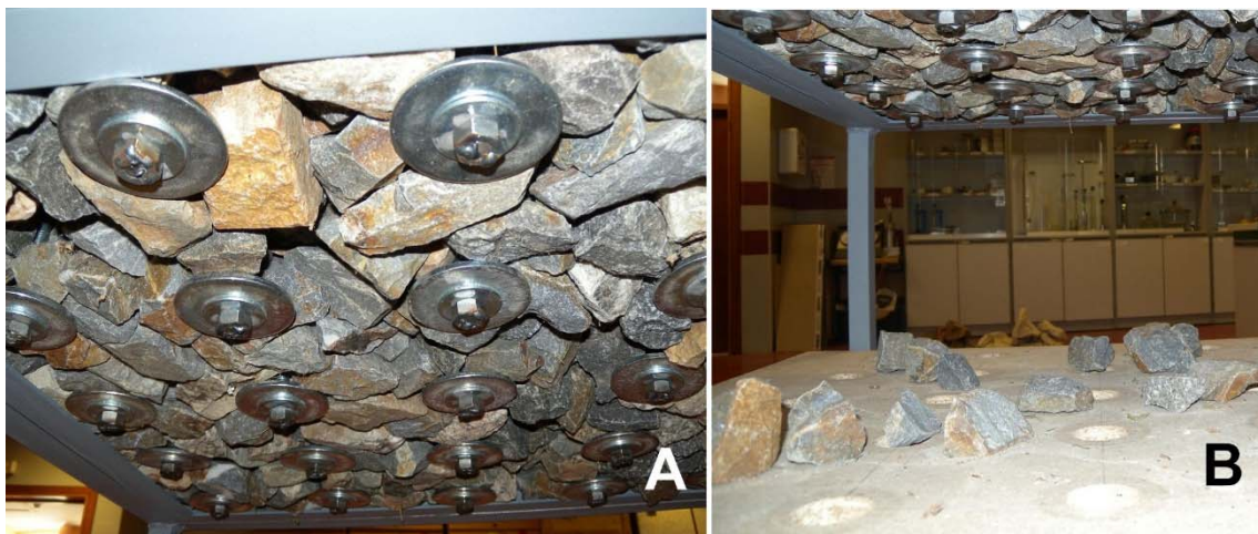
Figura 10. A) Vista inferior una vez retirado el panel. B) Fragmentos de roca caídos sobre el panel debido a que no quedan comprimidos.
