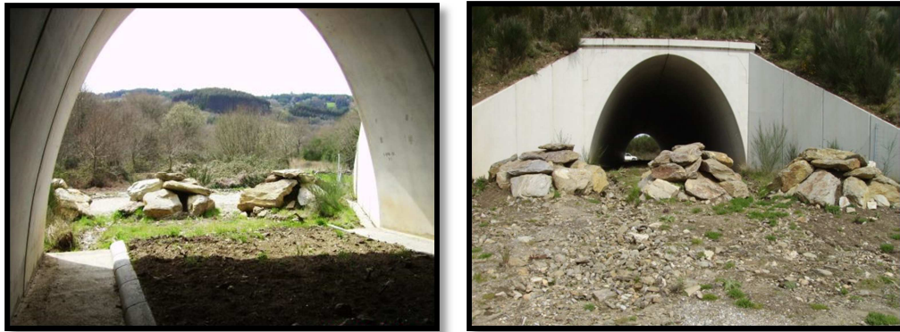
Imagen 24: Fotografías desde interior y exterior de paso inferior específico para fauna con colocación de piedras para bloquear el paso a vehículos, animales domésticos...(A-8 a la altura del municipio de Villalba, Lugo 2008)
