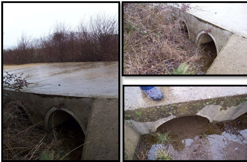
Imagen 13: Fotografías de drenaje bajo un camino agrícola cercano a la N-631. (2/2013)
