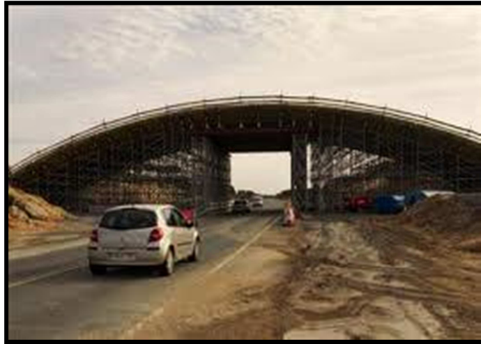
Imagen 13: Fotografía de un paso superior en construcción de las mismas características que el que se propone
