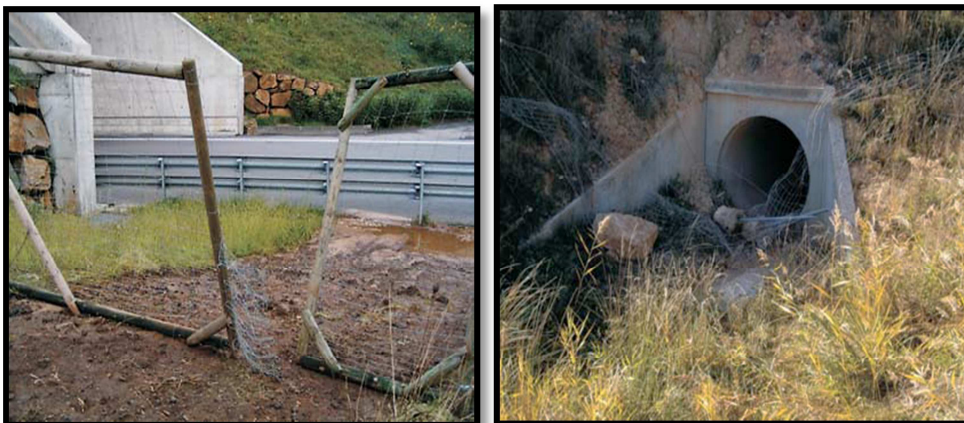
Imagen 7: Imágenes que muestran una clara deficiencia en el mantenimiento del vallado, facilitando el acceso de los animales a la vía (izquierda) o impidiendo que éstos utilicen los pasos de fauna (derecha). (MAGRAMA)
