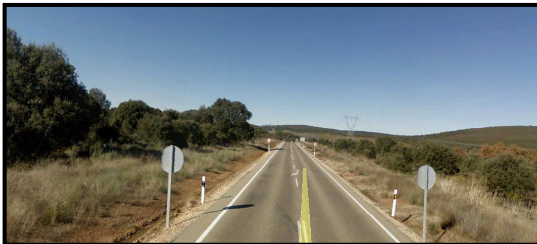
Imagen 9: Vista de la calzada a la altura del PK-32+926 (Google Earth)
