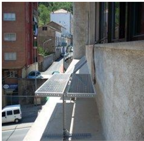
Ilustración 181: Módulos fotovoltaicos en la ETSII de Béjar
