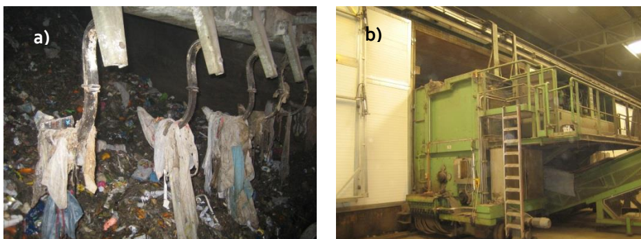
Figura 5.15. a) Alimentación al digestor b) Llenado/vaciado de túneles
