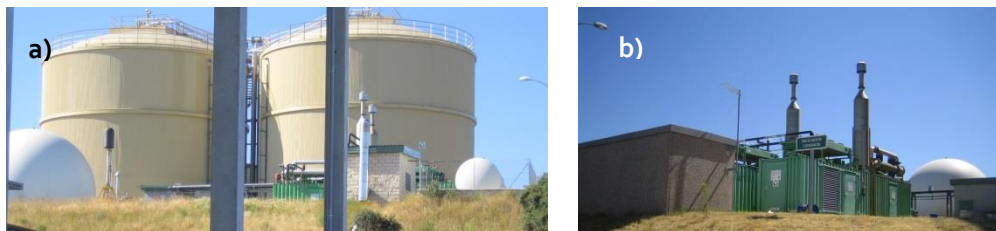
Figura 5.6. a) Digestores b) Módulo de cogeneración
