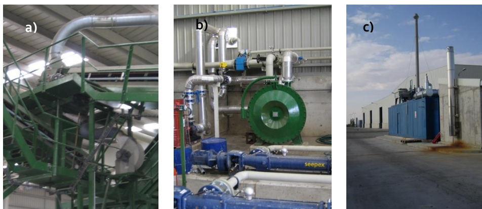
Figura 5.11. a) Recuperación de film automática b) Sistema de bombeo c) Módulo de cogeneración
