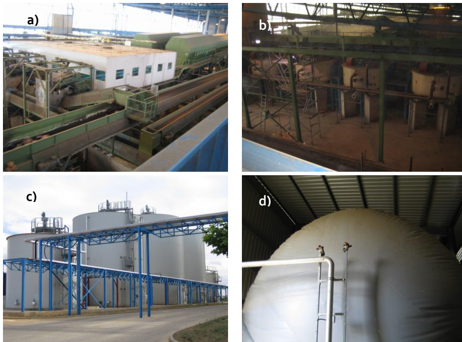
Figura 5.9. a) Cabinas triaje secundario b) Púlpers c) Digestores d) Gasómetro
