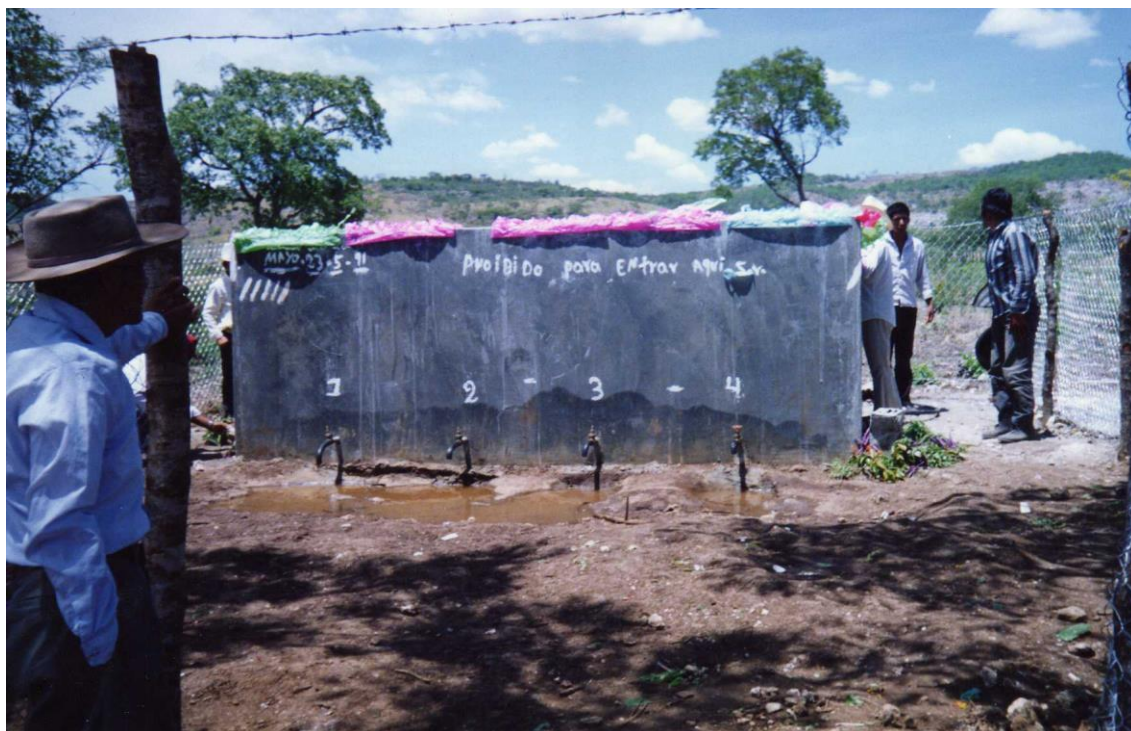
Fotografía 9: Sistema de bombeo de agua con tomas para los usuarios.
