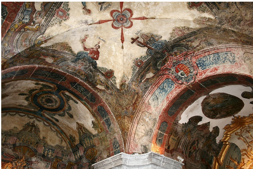
Imagem 6 Detalhe do teto pintado com arquiteturas fingidas, figuras alegóricas e o brasão da família Morais Sarmiento
