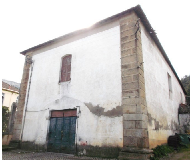
Imagem 1 Parte da estrutura arquitectónica que resta do desaparecido convento de São Francisco de Torre de Moncorvo
