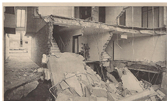
Los tabiques de una bodega, junto a los muros, se han desplomado en el barrio de la Bodega, en la Calle Rodríguez Chino.
