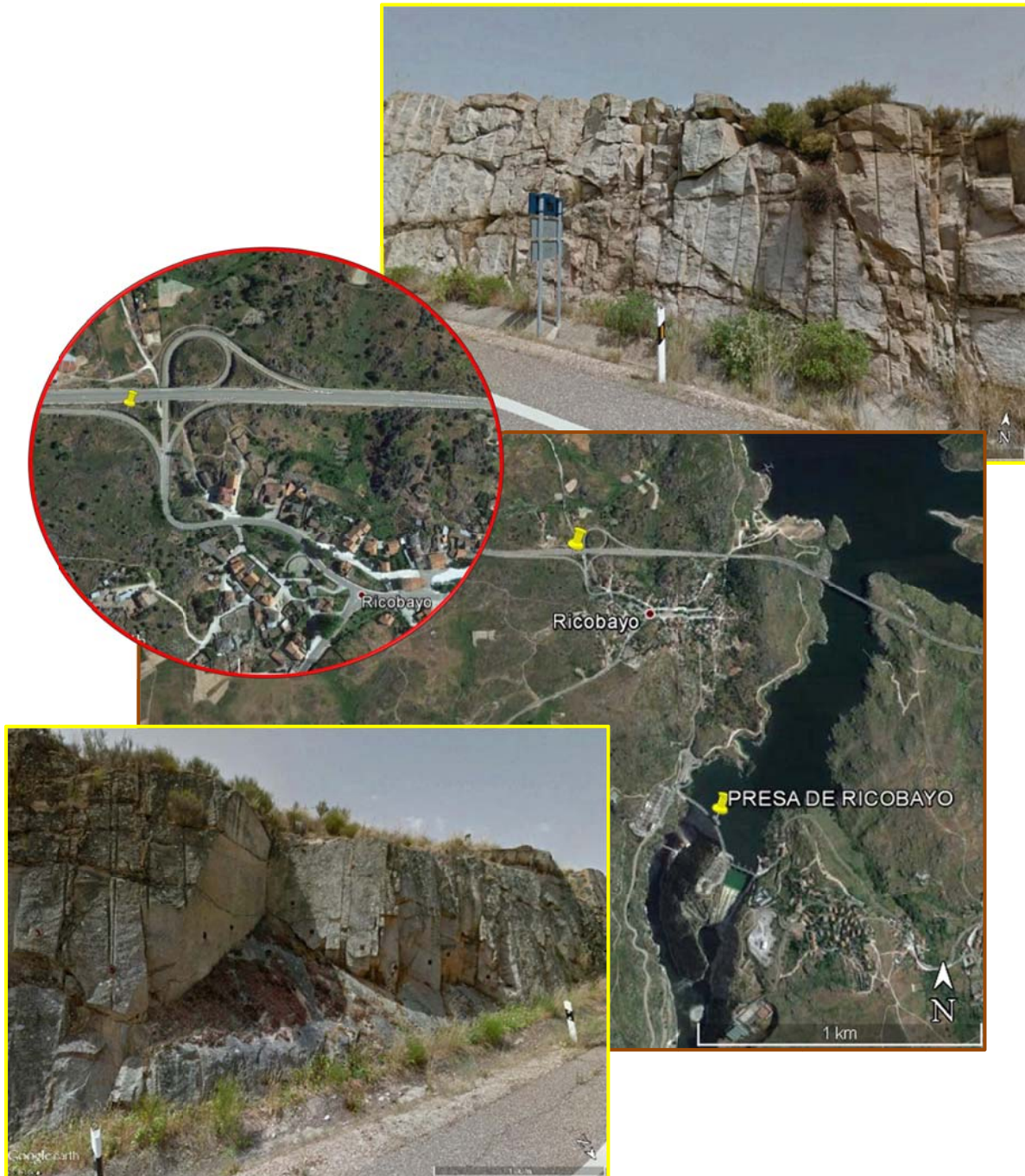
Figura 2. Taludes de la vía de acceso a Ricobayo (Zamora), desde la carretera N – 122. Imágenes de Google Earth y de Street View.
