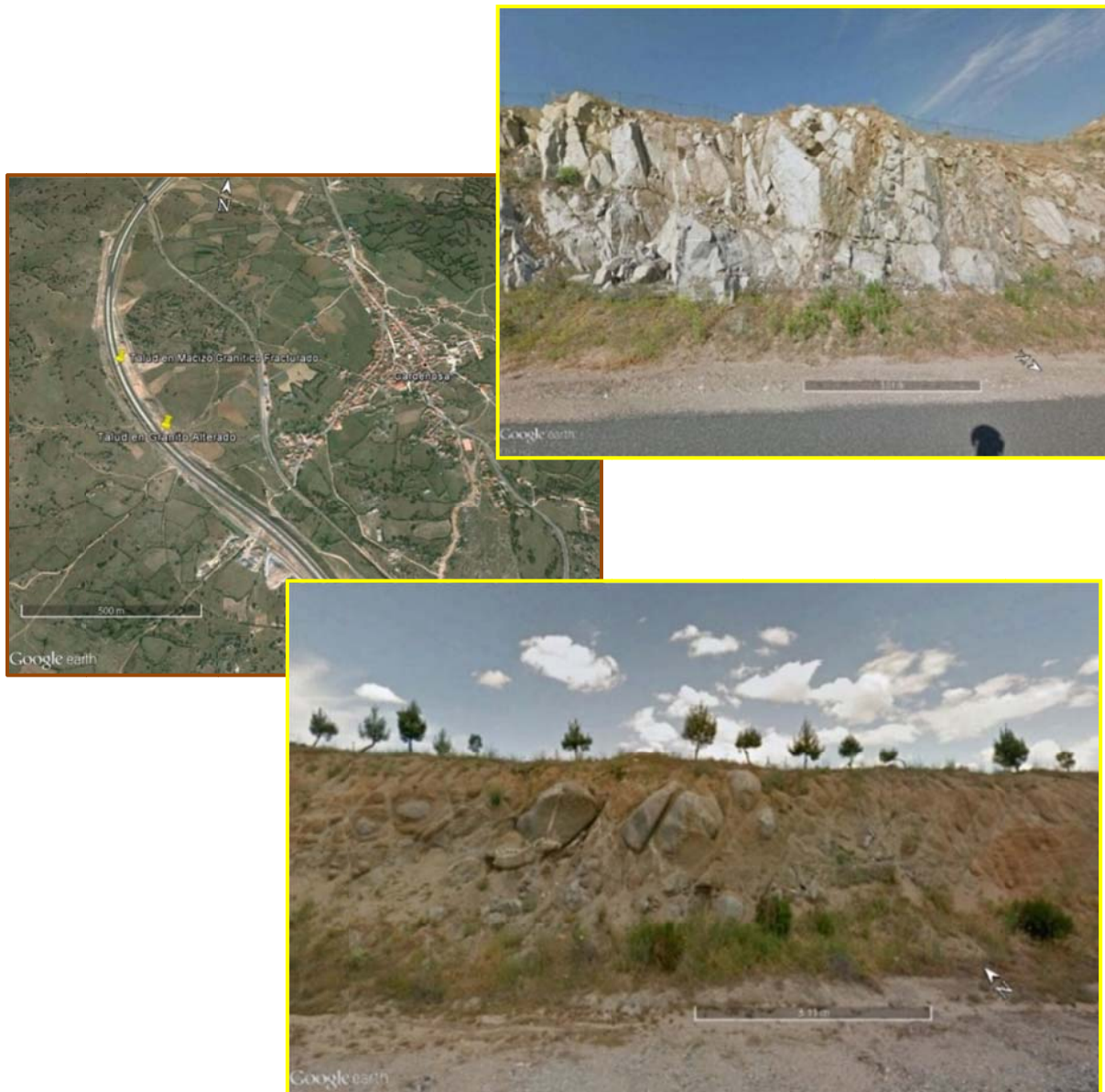
Figura 4. Taludes de la autovía A - 50 Salamanca - Ávila, en las inmediaciones de Cardenosa (Ávila). Imágenes de Google Earth y de Street View.
