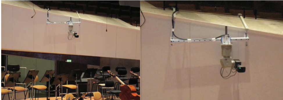
Figura 7 Soportes y modos de anclaje de las cámaras en la Philharmonie de Berlín.
