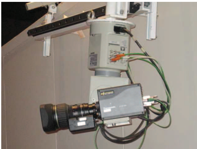
Figura 8 Soportes y modos de anclaje de las cámaras en la Philharmonie de Berlín
