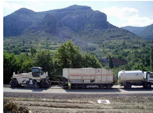
Figura 9. Acople de estabilizadora, dosificador de lechada y cuba de agua. Fuente: Soltec
