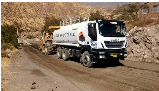
Figura 7. Acople de estabilizadora y cuba de agua. Dosificación por vía seca con humectación simultánea a la mezcla. Fuente: Alvac
