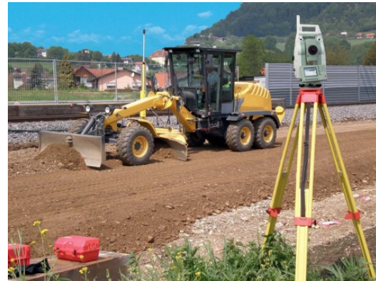
Figura 19. Motoniveladora con sistema 3D embarcado. En primer plano, estación total robotizada. Fuente: Mobile Automation
