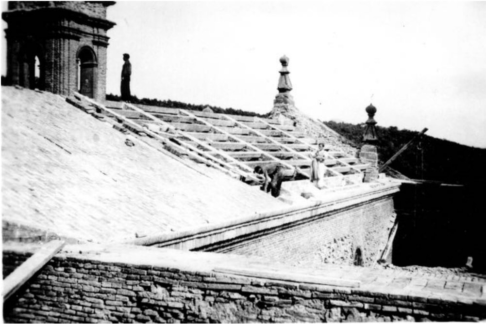
1. Cubierta del monasterio nuevo de San Juan de la Peña según el proyecto de Fernando Chueca Goitia en 1952, Fotografía del Archivo General de la Administración de Alcalá de Henares, Sección Cultura, Caja 253.
