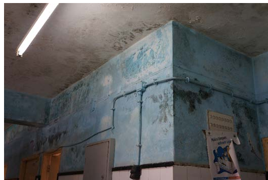
Figura 2- losa y paredes con infiltraciones.
