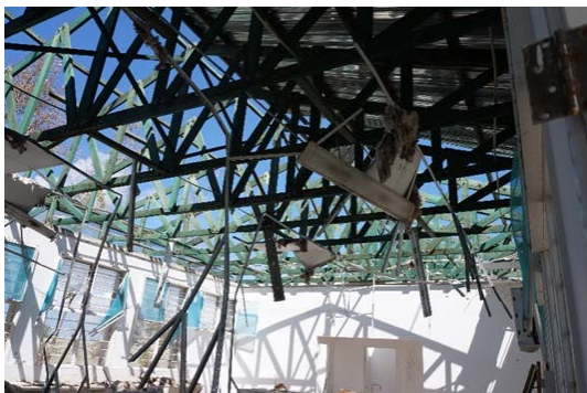
Figura 1 - Cubierta totalmente dañada.
