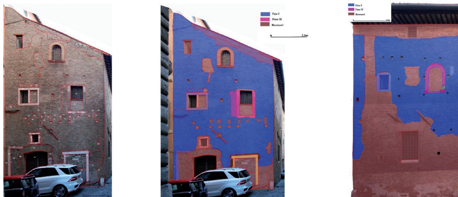
FIG. 3 Domus magna , via della Tribuna di Tor de Specchi, ricostruzione delle fasi edilizie dei prospetti Est e Nord.
