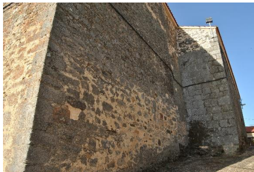
Imagen 21. Fachada norte del ábside y fachada este de nave lateral. Fuente: Elaboración propia
