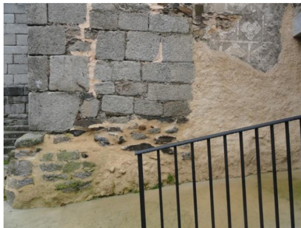
Imagen 41. Exceso de mortero de cal. Fuente: Elaboración propia
