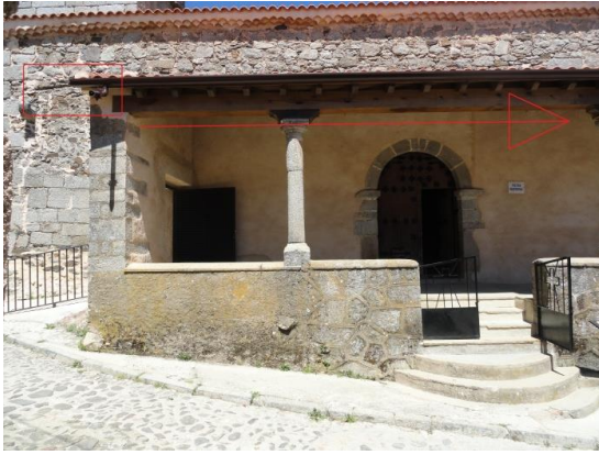
Imagen 13. Roza y restos de tejas como consecuencia del retroceso del pórtico. Fuente: Elaboración propia
