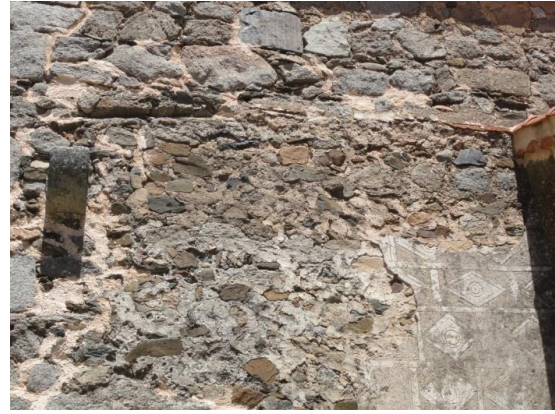
Imagen 14. Esgrafiado a la intemperie. Fuente: Elaboración propia
