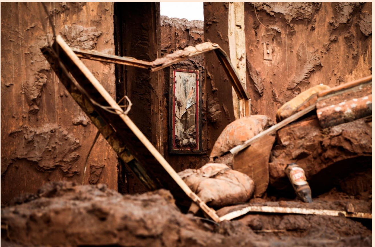
Interior del cuarto de una casa después del paso del tsunami de lodo/Interior do quarto de uma casa após a passagem do tsunami de lama (Bento Rodrigues, Minas Gerais).
