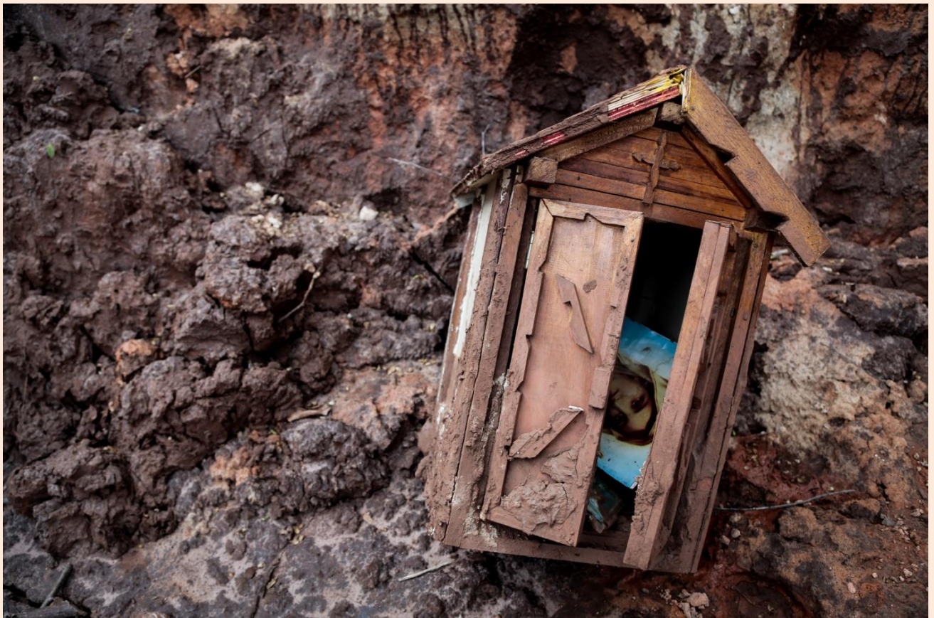
Oratorio encontrado entre los escombros de una casa /Oratório encontrado entre os escombros de uma casa (Paracatu de Baixo, Minas Gerais).
