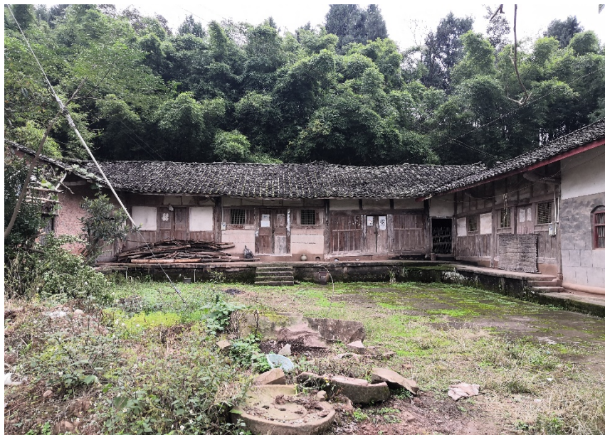
Foto 12: De lo que queda de la época, la escuela primaria del tercer pueblo
