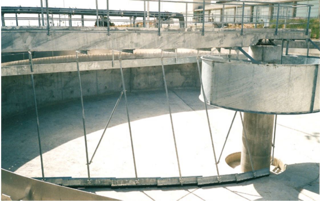
Figura 6. Fotografía de un decantador sin agua
