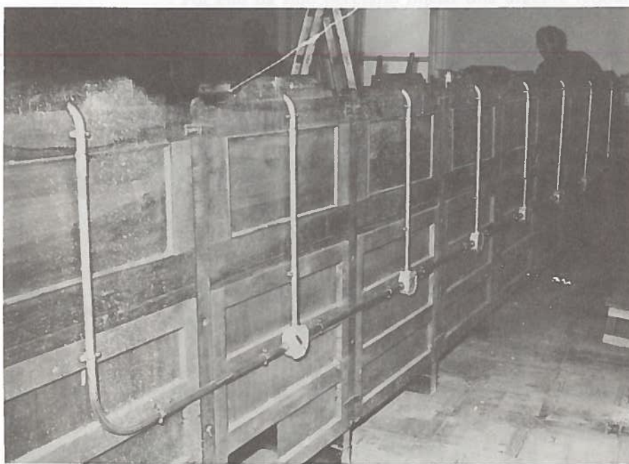
Nueva instalación eléctrica montada en dichas mesas en 1977
