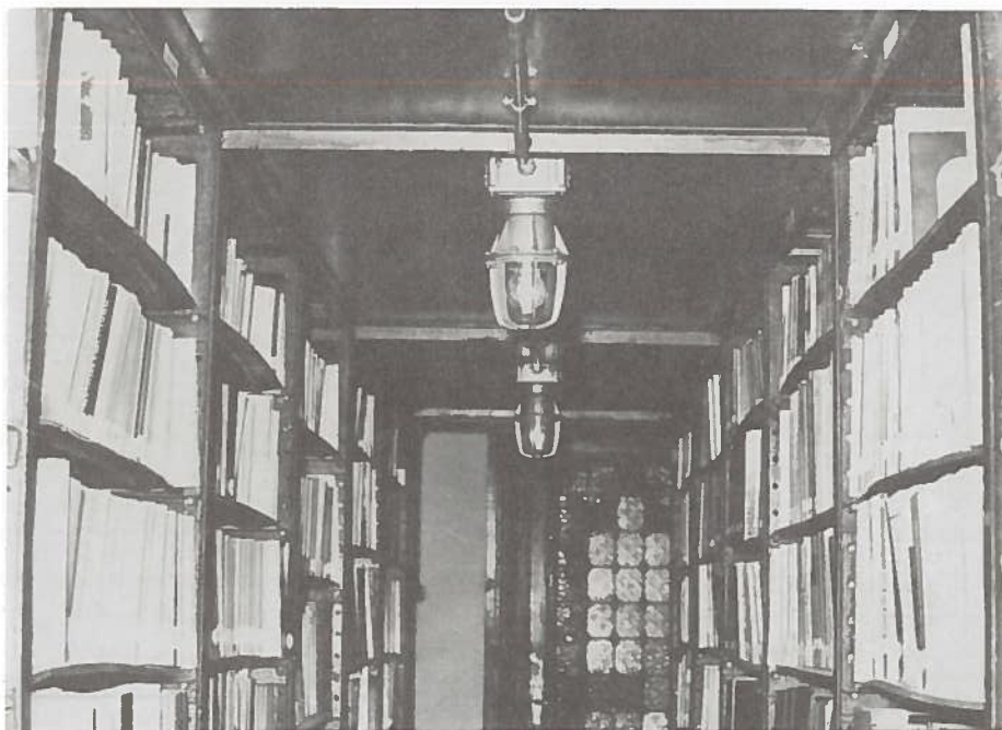
Nueva instalación eléctrica de seguridad, montada en el año 1977
