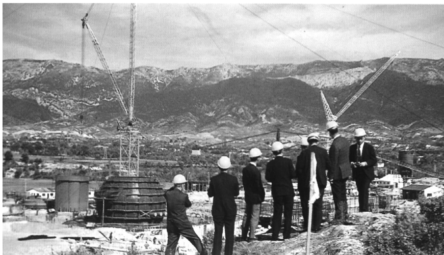
Obras de construcción del reactor de la central nuclear de Garoña. Fuente: SNE.
