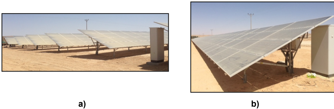
Fig 3.5: (a) y (b). Resultado de tormentas de arena sobre los paneles solares . [19]
