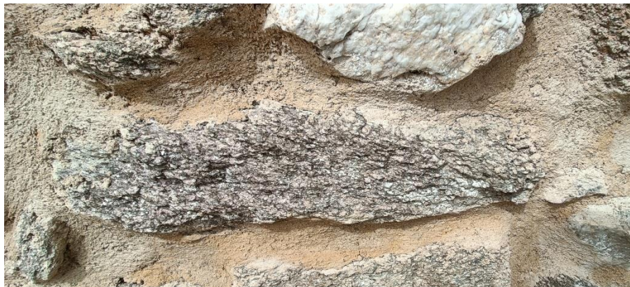
Figura 27. Ejemplo de granito con deformación en la fachada de un edificio.
