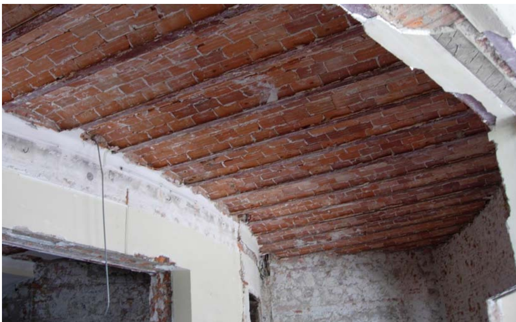
14: Escuela Normal de Zamora. Forjado de viguetas metálicas y entrevigado de rosca de ladrillo.
