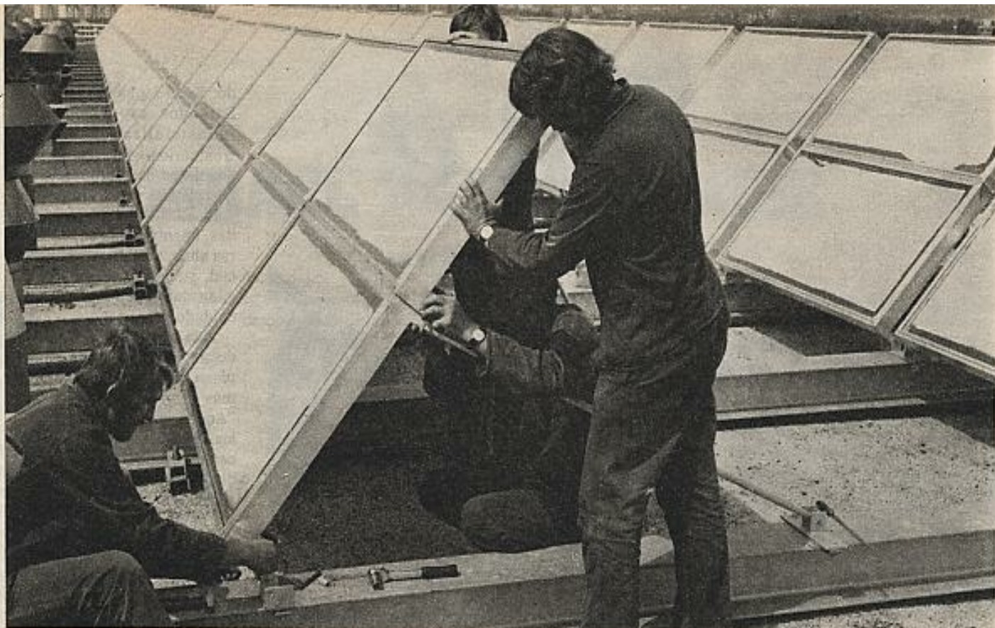
Paneles para el aprovechamiento de la energía solar instalados en el centro de investigación de Siemens, en Erlangen, Alemania.
