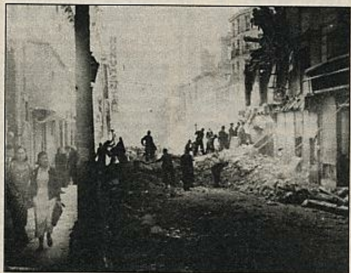
Trabajos de descombro en la madrileña plaza de Antón Martín tras un bombardeo de la aviación franquista.
