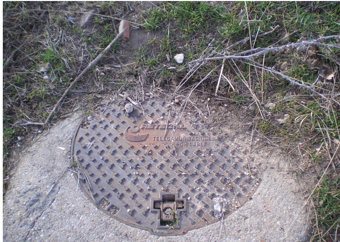
Arqueta de telecomunicaciones por cable, Retecal
