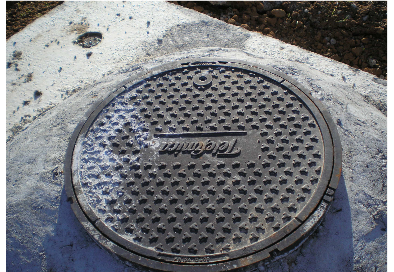
Imágenes de arqueta de Telefónica P.K. 1+820
