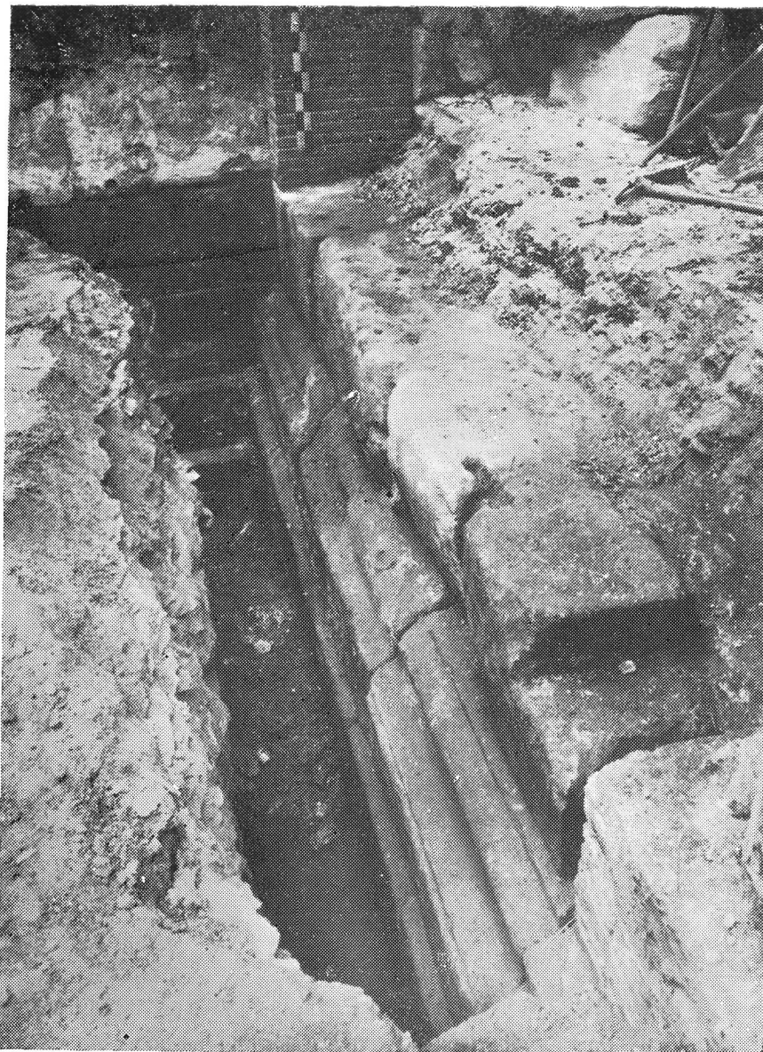
Comienzo de las excavaciones en la muralla de la calle de la Tapinería. Basamento del sector de muro entre las torres 12 y 13, conservando tres hiladas sillares, la intermedia formada por una cornisa invertida. El relleno, detrás de estos sillares, no ha sido excavado. En el fondo, el basamento de la torre 13
