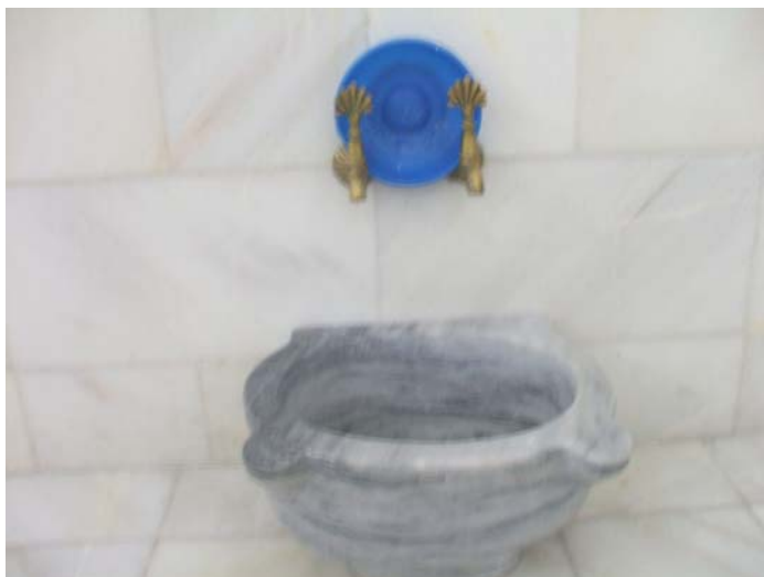
Ilustración 29 Pila para el baño Turco. Imagen tomado en un hammam en la zona de la Capadocia en Turquía
