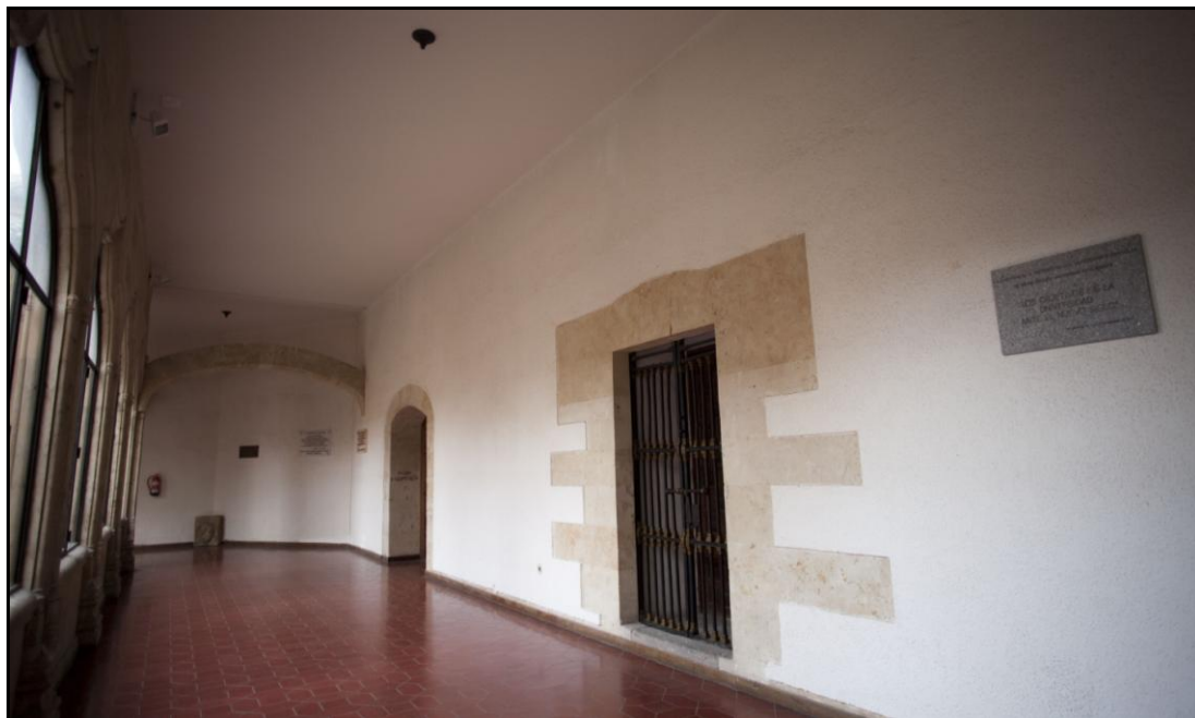
Galería sur del claustro alto donde se encontraba el pequeño corredor, con las actuales puertas del coro y de la sala de claustros
