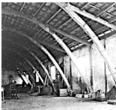
Fig. 182. Catenarias en la nave de la Cooperativa Mataronesa. Fuente: RAMÍREZ, J. A. La metáfora de la colmena... , p. 54.
