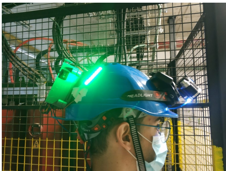
FIGURA 3.23: Casco en la evaluación en un centro de transformación con alarma de gases activada.
