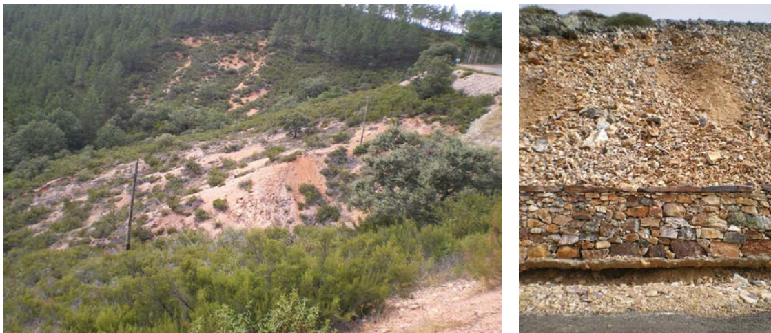
Figura III 4.1 -44. Izq: Procesos de erosión intensa que favorecen la remoción en masa de las formaciones superficiales. Monsagro. Dcha: Desestabilización del muro de contención de un canchal. Paso de Los Lobos. Monsagro.
