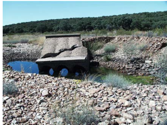
Figura II 5-1 . Los elevados caudales y la carga de sólidos producen roturas y derrumbes de puentes situados en los cauces ordinarios. Río Yeltes en Puebla de Yeltes.
