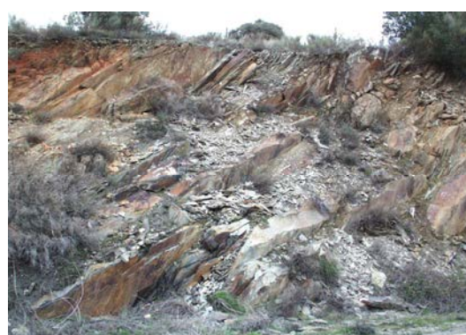
Figura III 4,1 -39. Rotura con vuelco en talud de cuarcita armoricana. Pastores.
