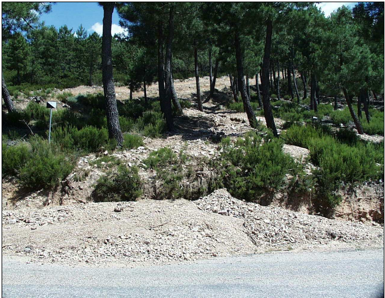
Figura III 2.1 -3. Abanico de depósito por Erosión laminar afectando a carretera. El Maillo.
