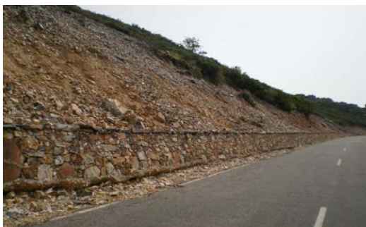
Figura III 4,1 -49. Pendientes altas provocan la rotura del muro contención. Monsagro.
