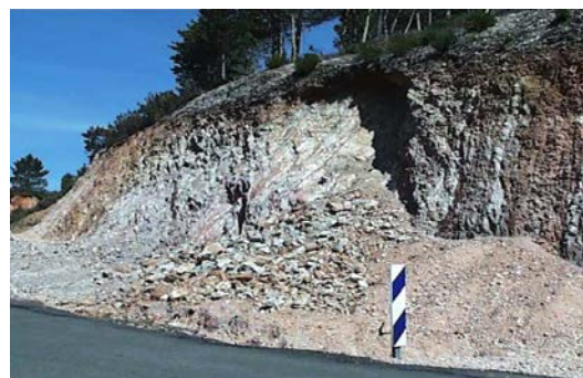
Figura III 4,1 -38. Rotura en cuña en talud de cuarcita armoricana. Monsagro.
