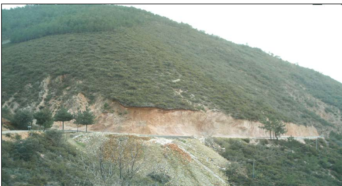
Figura III 4,1 -18. Morfología de ladera, donde se aprecia una curvatura convexa en zona alta y rectilínea (sector acaravado) en zona media, provocando reptaciones y desprendimientos en el corte del talud de carretera). Ctra. Ciudad Rodrigo – Monsagro.
