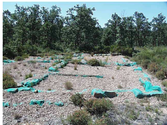
Figura II 9-18 .Excavación y protección mediante su cubrimiento de restos de un poblado romano. Las Cavenes. El Cabaco.
