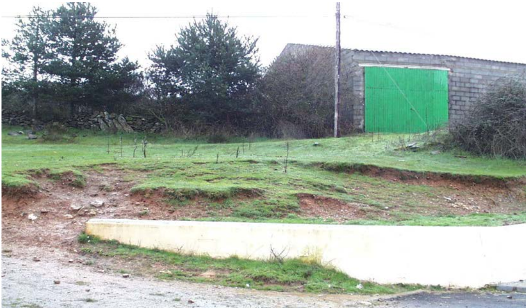
Figura III 4.1 -42. Deslizamiento superficial con reactivaciones en épocas de intensas precipitaciones. Serradilla del Llano.
