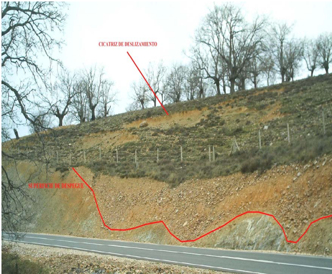
Figura III 4.1 -21. Deslizamiento traslacional en ladera de baja inclinación (sector de susceptibilidad media), en el que se aprecia en el talud de carretera la potencia y nivel de despegue. El Maillo.
