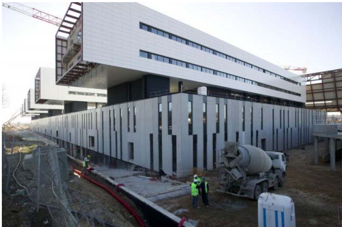
Figura 01. Imágenes del Hospital General San Joan de Reus durante la ejecución de su obra (2006-2010)
