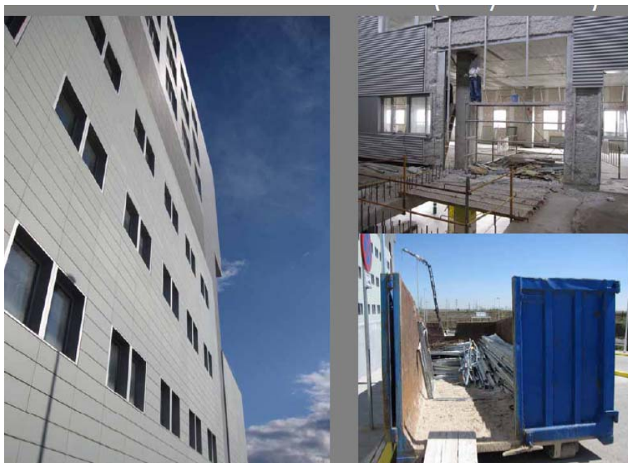
Figura 36. Ampliación del Hospital Infanta Sofía en mayo de 2009. Fuente: Extraído de Fernández, (2009) ¿Podemos diseñar y construir hospitales más eficientes en el futuro?
