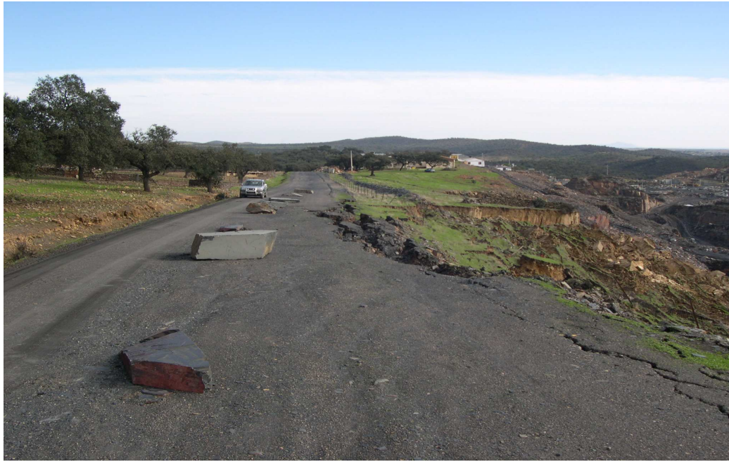
Imagen 18. Rotura de talud tipo circular en macizos rocosos alterados. Flanco Norte Pizarras Villar del Rey (Badajoz). Fuente: Aportación Dirección Facultativa de Cantera. Año 2007.
