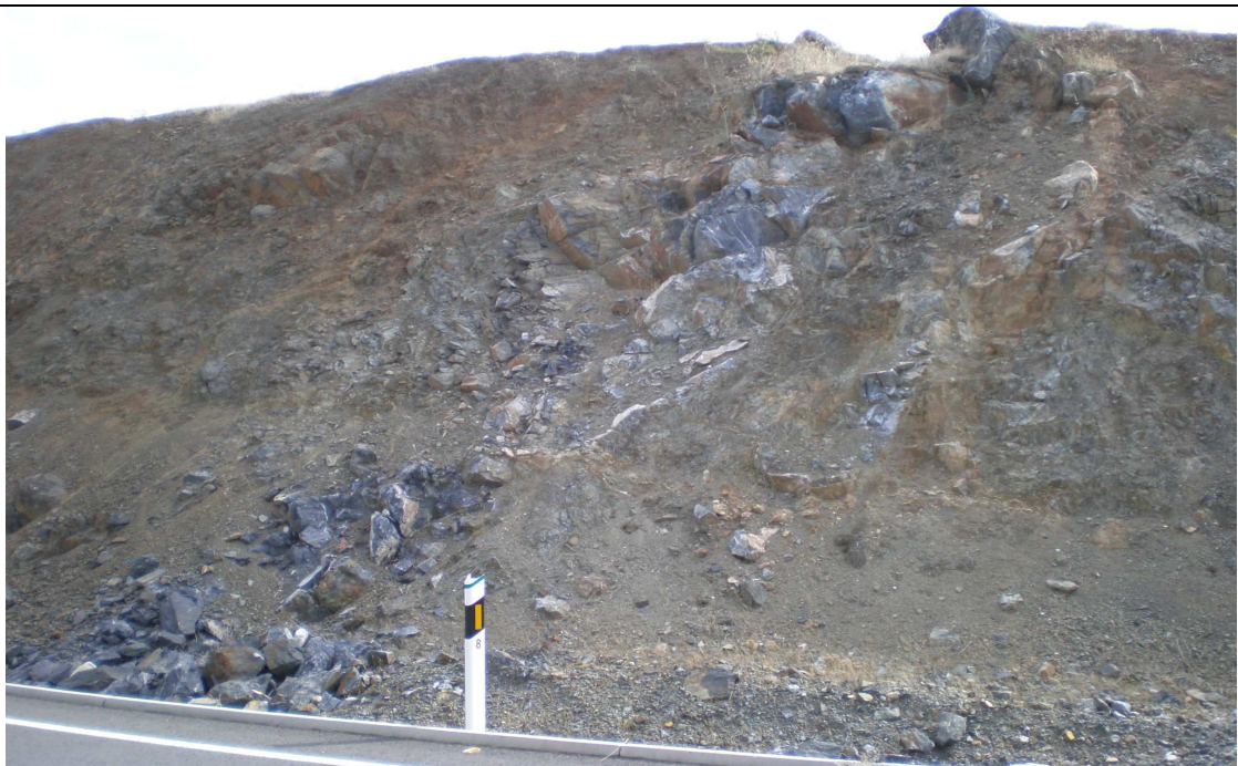
Fotografía 14. Vista particular de estructura tipo Sill, en el talud derecho excavado en la EX.-214. La Roca de la Sierra-La Nava de Santiago. Marzo 2.010.
