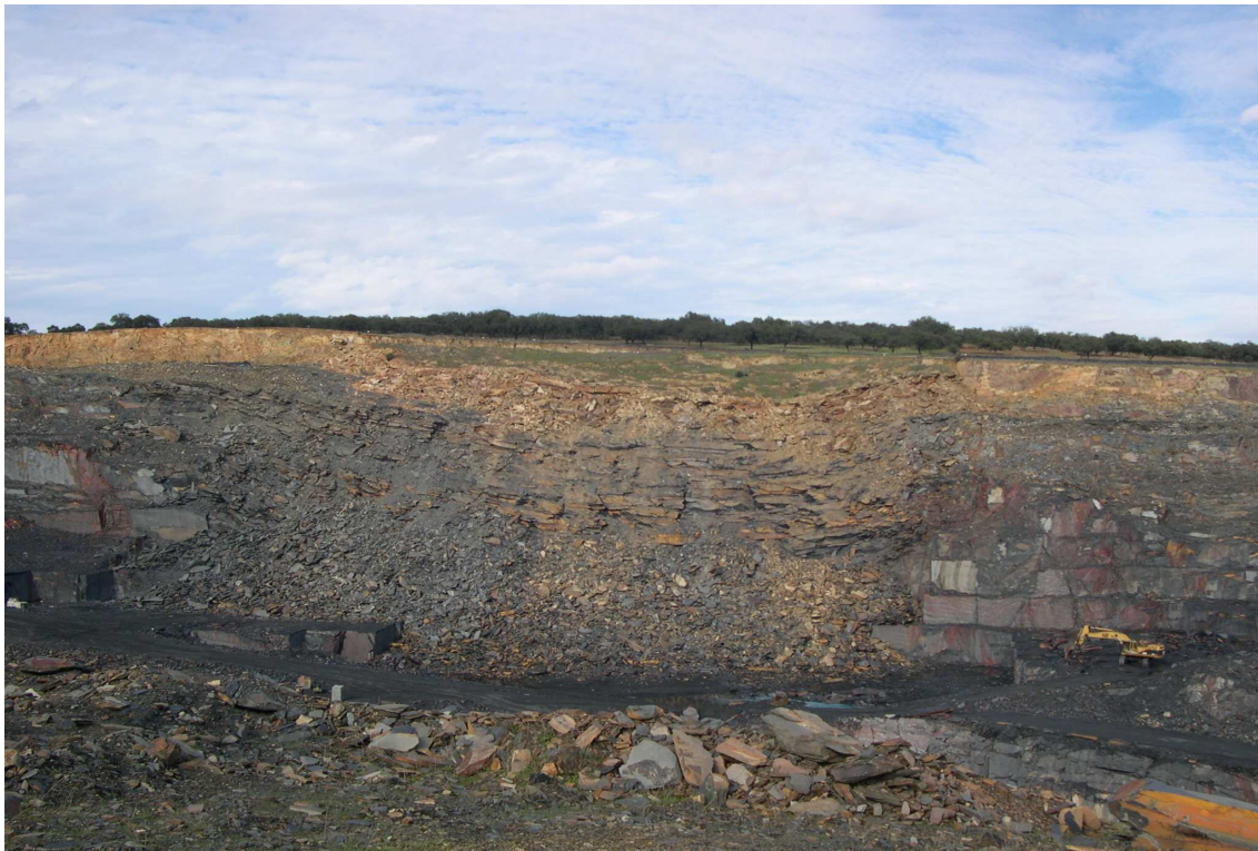
Imagen 19. Rotura de talud tipo circular en macizos rocosos alterados. Flanco Norte Pizarras Villar del Rey (Badajoz). Fuente: Aportación Dirección Facultativa de Cantera. Año 2007.
