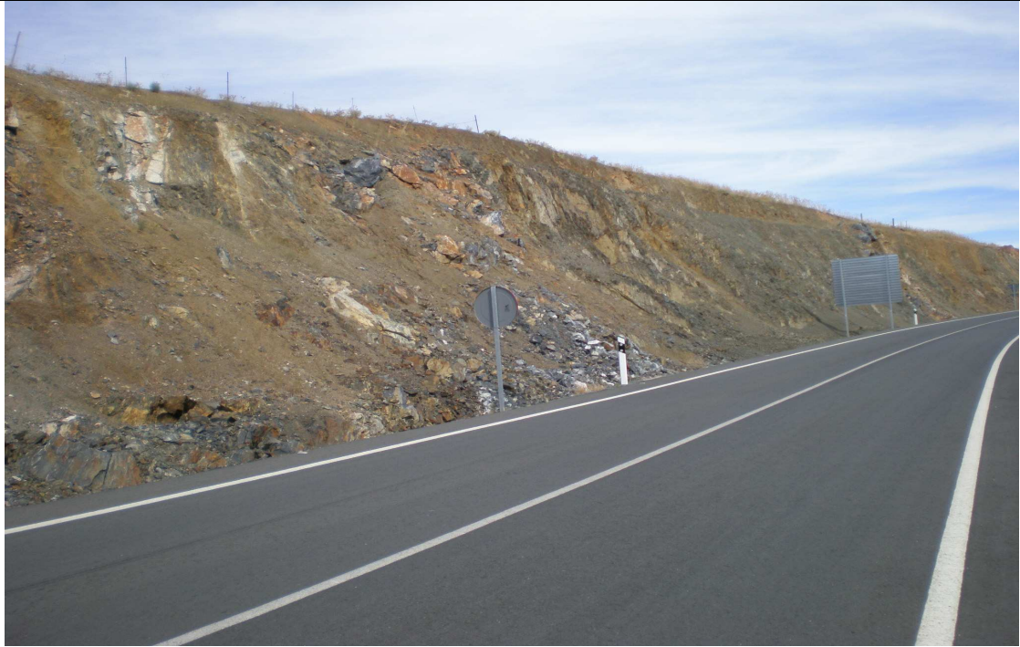
Fotografía 11. Vista general de desmonte, talud izquierdo cercano al desmonte proyectado P.K. 5+800 a P.K. 6+500 excavado en dirección perpendicular al mismo en la EX.-214. La Roca de la Sierra-La Nava de Santiago. Marzo 2.010.
