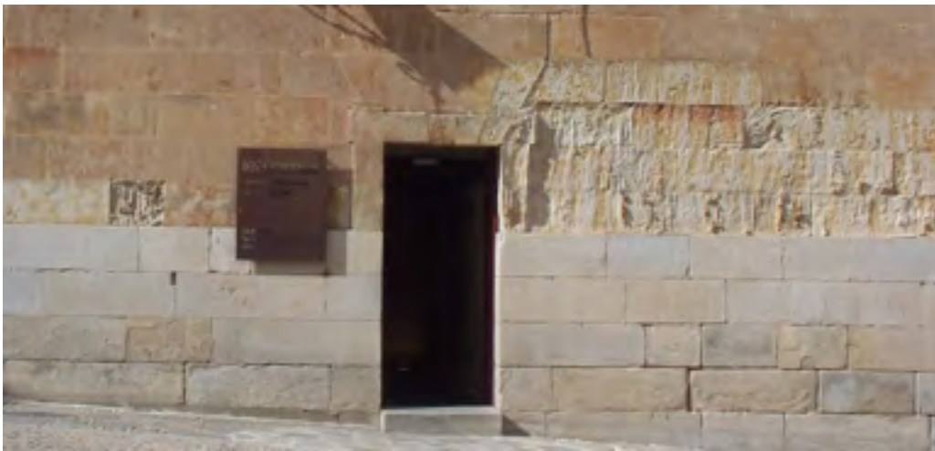
Figura 15: Entrada a la exposición Ieronimus, torre de la Catedral Nueva. Se aprecia la combinación de la arenisca de Villamayor (parte superior) con el granito de Martinamor (inferior). Y el deterioro de la arenisca debido a la acción del viento y el agua.
