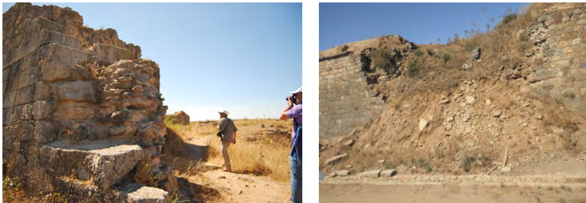
Figura 46: En la primera imagen se observa un muro en el que se aprecia su grosor y en la segunda se contempla un muro de contención deteriorado.
