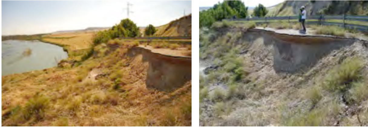
Figura 28: Reinoso del Cerrato. Carretera cerrada afectada por el deslizamiento.
