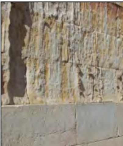
Figura 16: Alteración en la arenisca de Villamayor, producida por capilaridad, ya que se encuentra sobre el granito que es impermeable y la pequeña lámina de agua que queda sobre el granito cuando llueve es absorbida por la arenisca.
