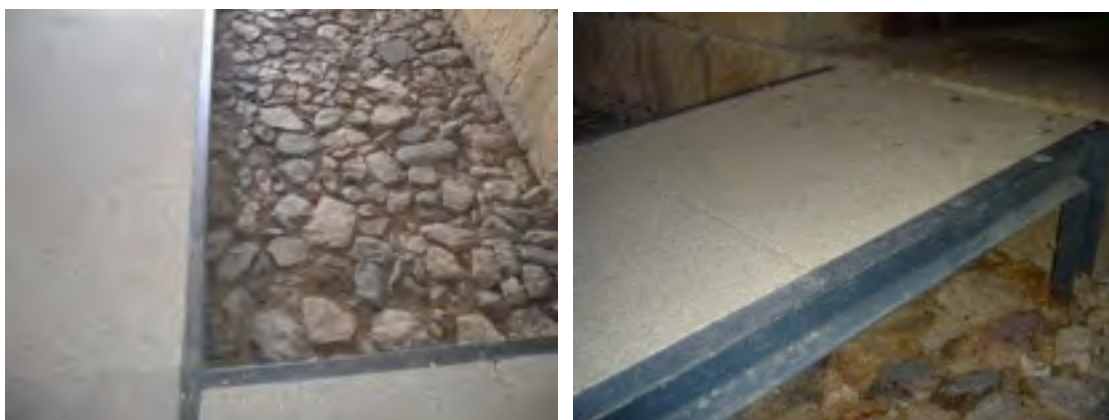
Figura 50: Se aprecia el suelo original en la primera imagen, empedrado. En la imagen de la derecha se observan las placas de granito, situadas por encima del suelo original como medio de conservación del mismo.
