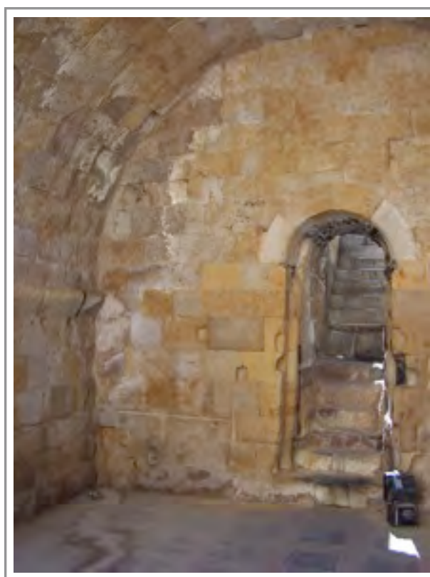
Figura 19: Cueva de Salamanca, se presentan signos claros de eflorescencias salinas y de desgaste, probablemente causa de la percolación de agua de la parte superior.
