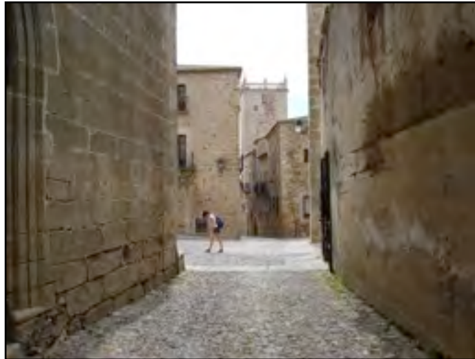
Figura 21: En la parte derecha de la imagen se observan eflorescencias salinas. En la izquierda, se observa como la parte baja de la pared, se encuentra más deteriorada que la parte superior de la misma.
