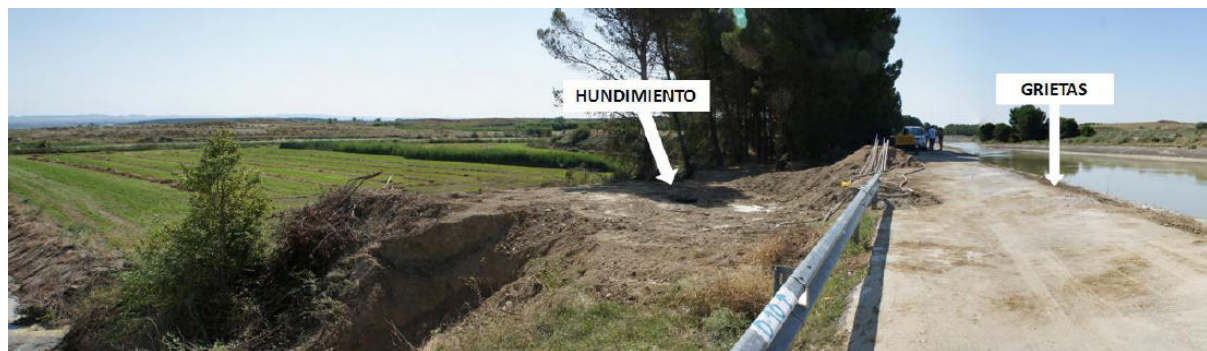
Imagen 8. Panorámica de la zona de estudio situada en la margen izquierda del Canal de Monegros. Se pueden visualizar el canal (izda), la carretera de servicio que se hundió y donde aparecieron grietas y el hundimiento aparecido en las inmediaciones de la carretera, así como la zona de cultivos que se vieron anegados
