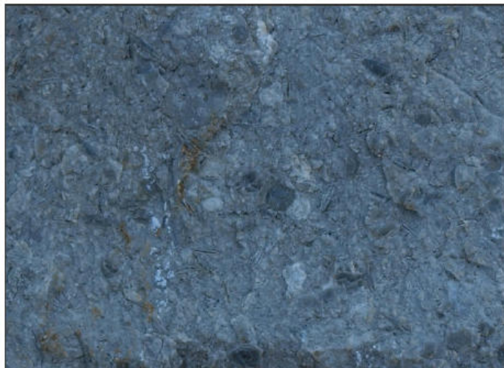
Imagen 24. Detalle de la textura de la caliza de alveolinas del estribo izquierdo de la presa
