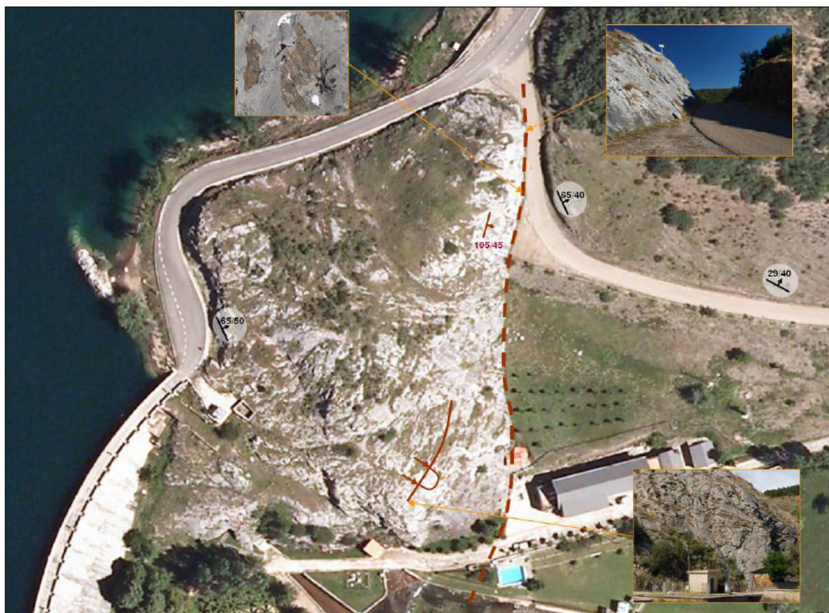
Figura 264. Observaciones en el estribo izquierdo de la presa
