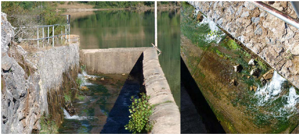
Figura 293. Múltiples puntos de descarga hacia el aliviadero de filtraciones generadas en el embalse las cuales circulan a través de la esquina noroeste de la zona de estudio hasta su descarga.
