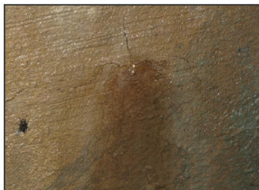
Imagen 34. Filtración a través del revestimiento
