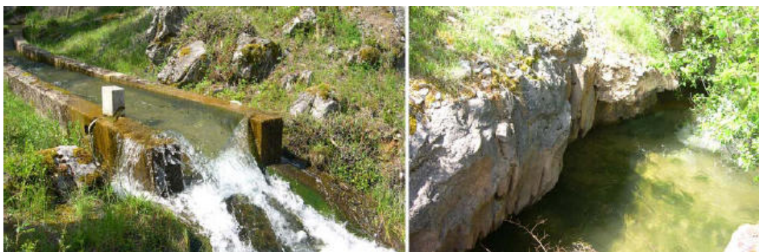
Imagen 38. Azud de recogida de las filtraciones del estribo derecho (izda) y surgencia de las filtraciones (dcha)
