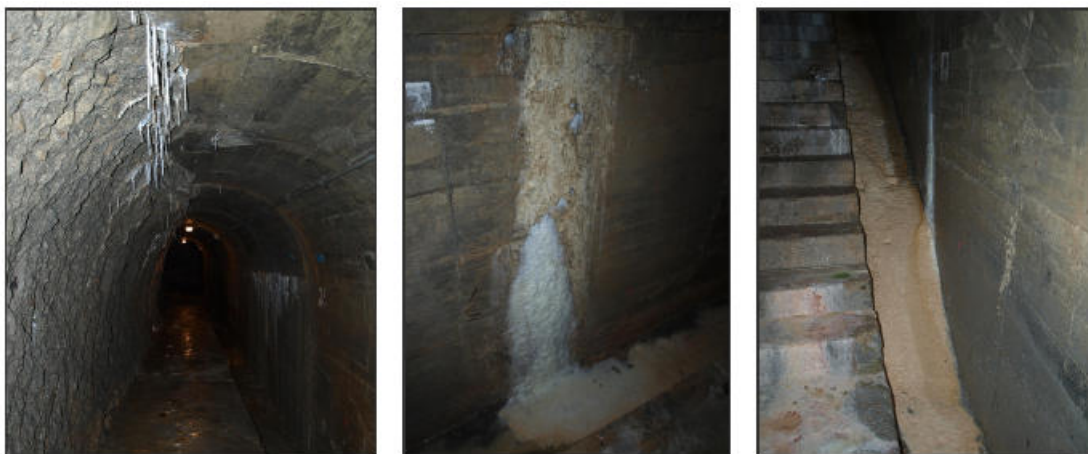
Imagen 33. Precipitados en las galerías interiores de la presa
