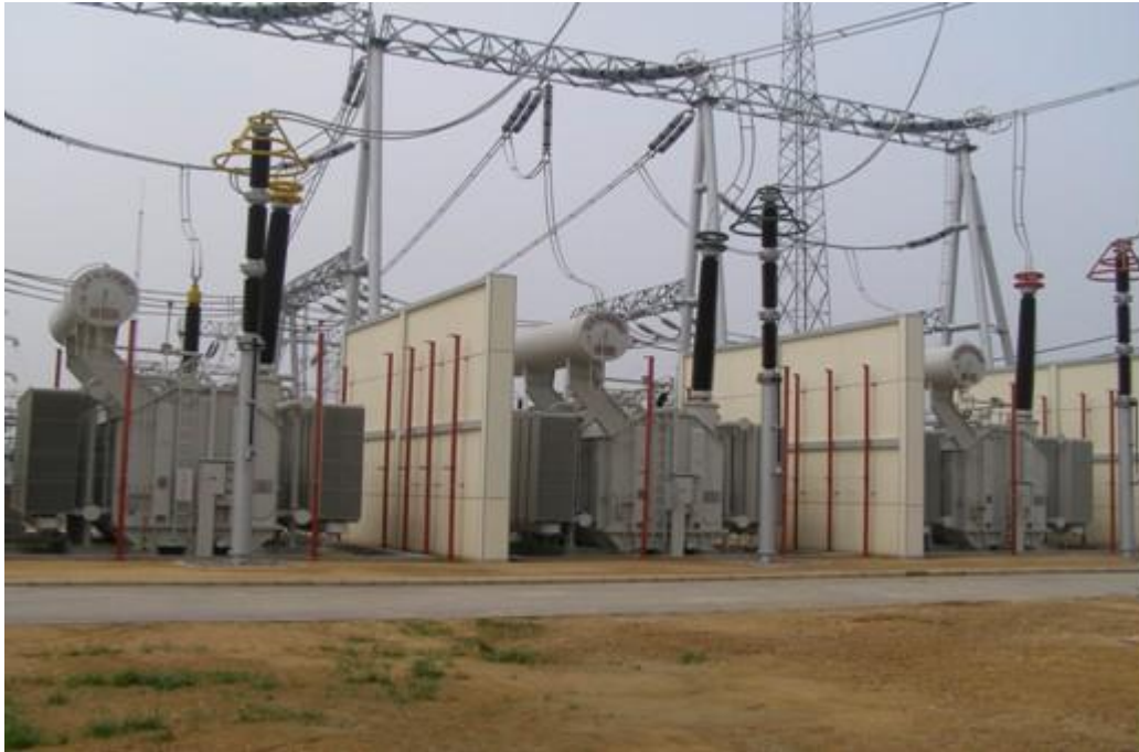
Figura 3.6.1. Transformador de potencia de muy alta tensión.
