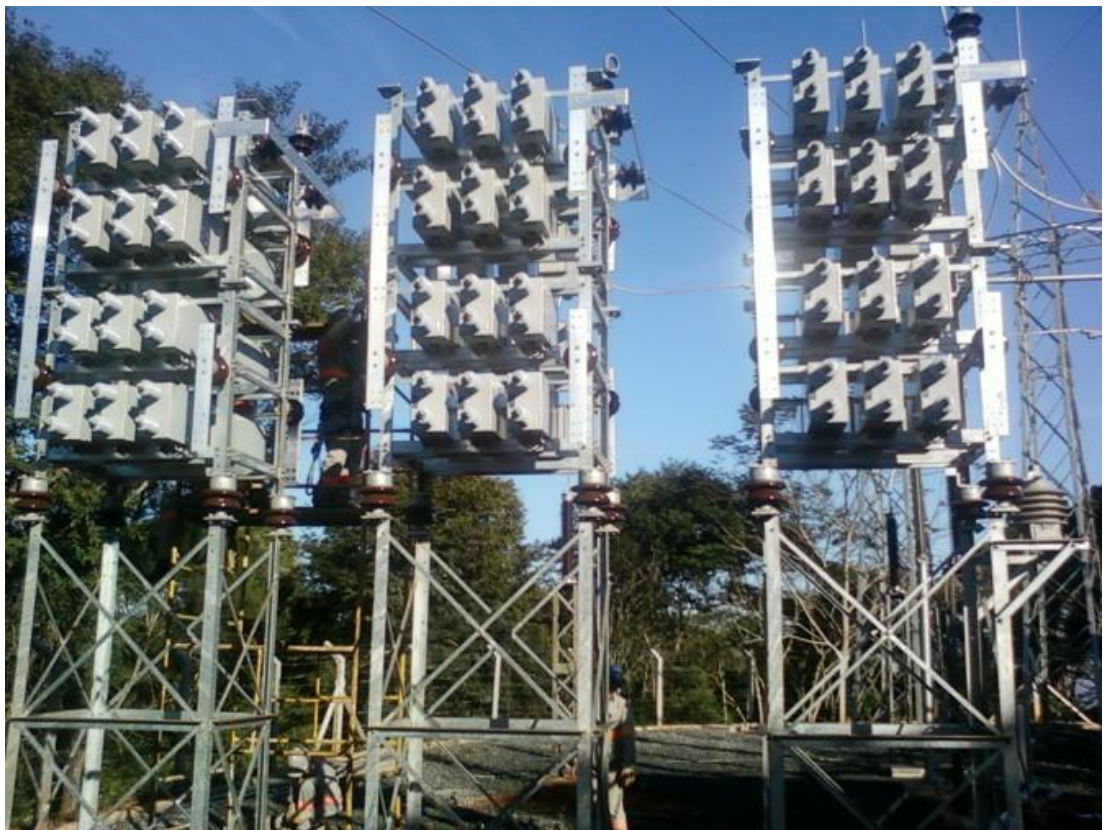
Figura 3.4.1.10. Banco de condensadores.
