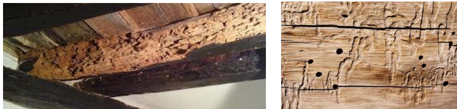
Figura 2-29. Daños en la madera por efecto de xilófagos.
