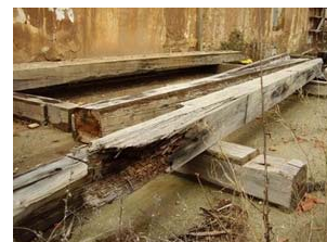
B) Viga de tirante degradada por pudrición parda propagada desde la unión tipo clavija.
