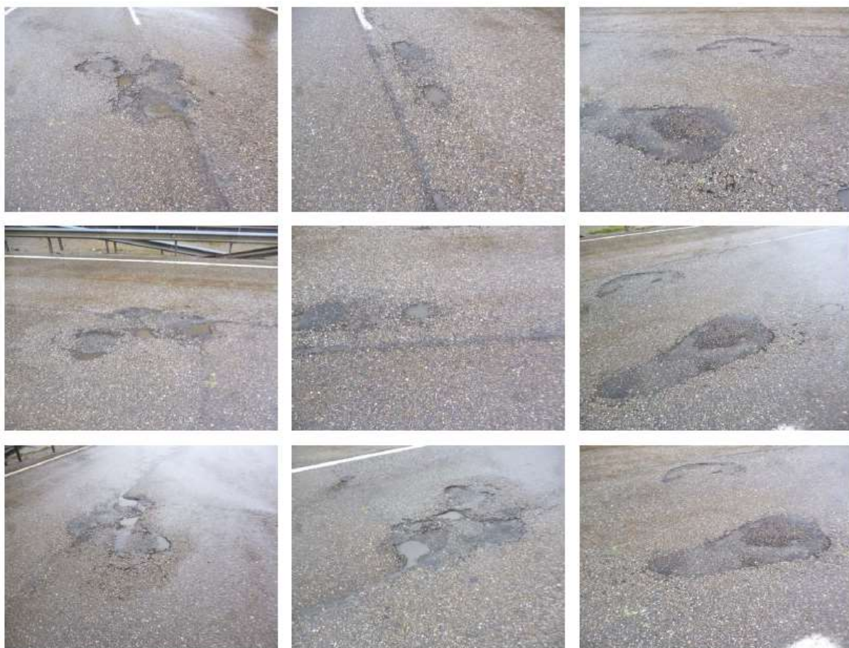
Fig. 5.27. Estado del firme: inspección visual realizada en 2014 (AC16 surf B50/70).
