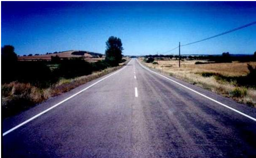
Fig. 2.26. Sangrado de las zonas de rodadura por exceso de betún en la mezcla bituminosa.
