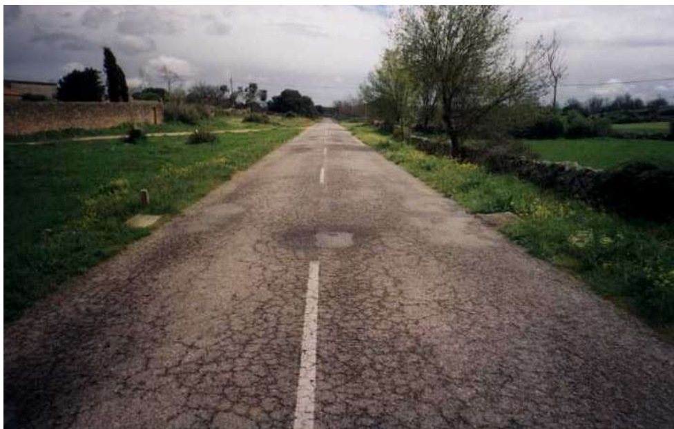
Fig. 2.22. Firme cuarteado en malla fina (piel de cocodrilo).
