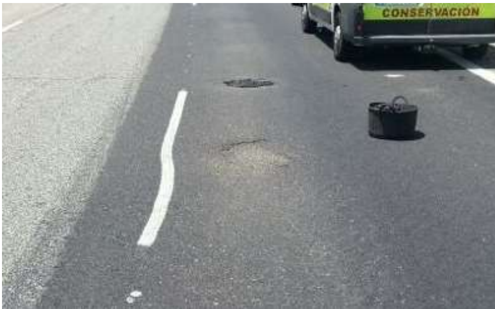
Fig. 2.14. Desplazamiento de un firme flexible debido a las altas temperaturas.
