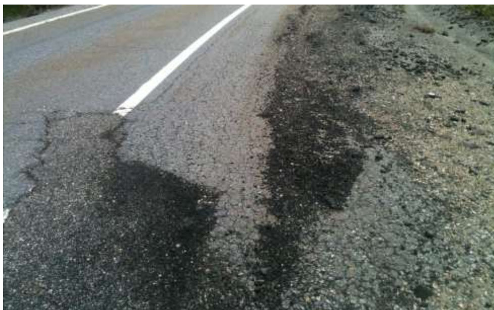
Fig. 2.1. Grietas debidas al fallo de la explanada.
