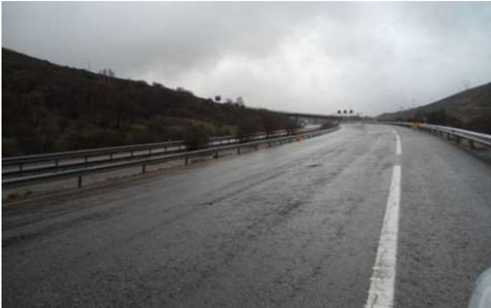
Fig. 2.15. Daños producidos por ciclos hielo-deshielo.
