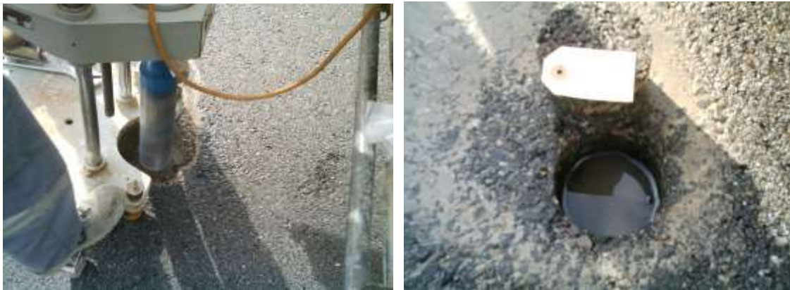
(a) (b) Fig. 4.9. Extracción de testigos de la calzada. (a) Corte con sonda rotativa. (b) Identificación.
