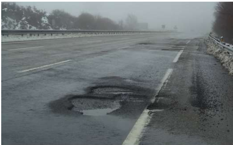
Fig. 5.23. Patologías presentadas por la MBC en la carretera objeto de estudio. Capa de rodadura tipo AC16 surf PMB 45/80-60 S.
