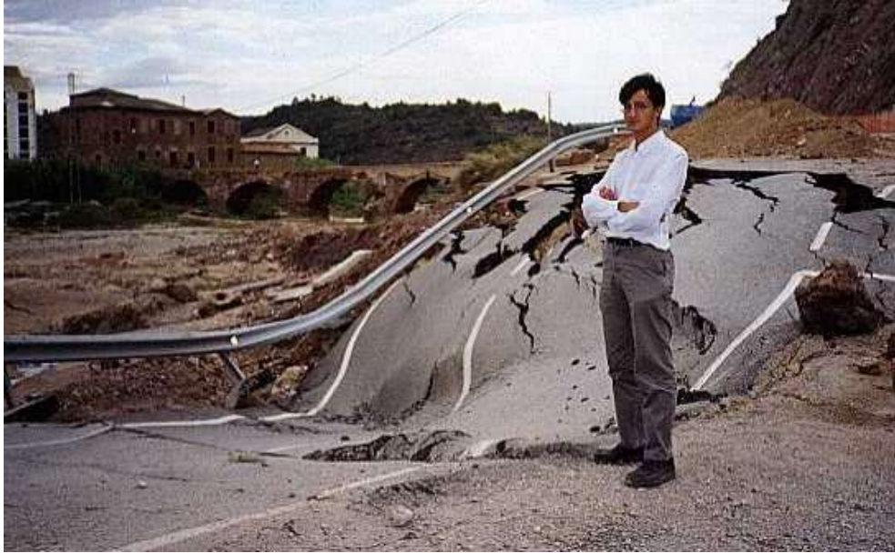
Fig. 2.2. Ruina del firme por fallo de la explanada.
