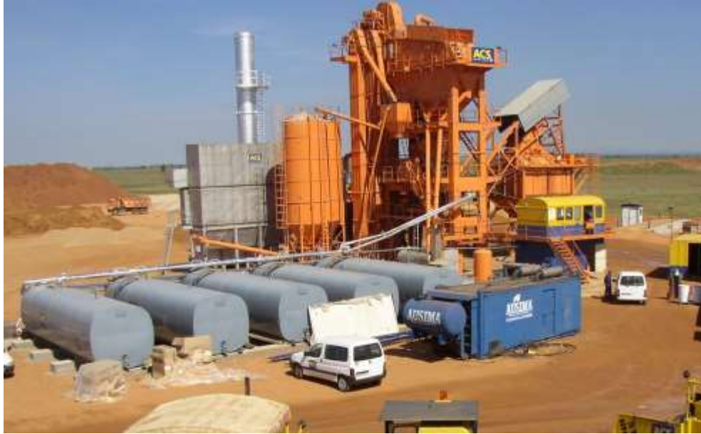
Fig. 3.3. Planta de fabricación de MBC de tipo discontinuo.
