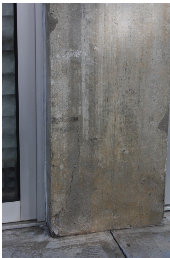
Figura 130. Escola Secundária Cristina Torres. Fissuras na estrutura de betão. (Foto: Ana Cação)
