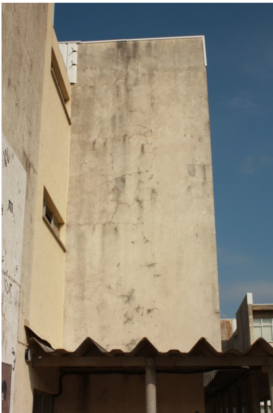
Figura 32. Escola Secundária Cristina Torres. Vista sobre um bloco de aulas (Foto: Ana Cação)
