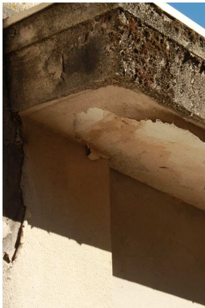
Figura 116. Escola Secundária Dr. Bernardino Machado. Pormenor da colonização biológica na fachada principal do pavilhão gimnodesportivo. (Foto: Ana Cação)
