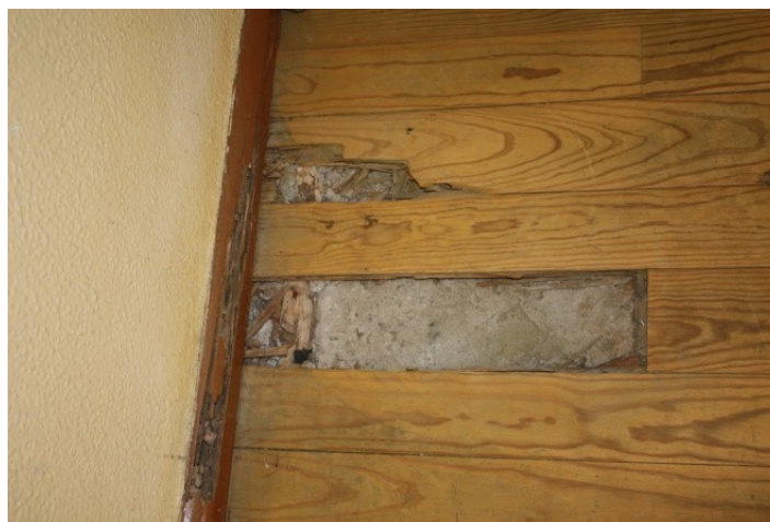
Figura 121. Escola Secundária Dr. Bernardino Machado. Pormenor da deterioração do soalho de pinho de uma sala de aula. (Foto: Ana Cação)
