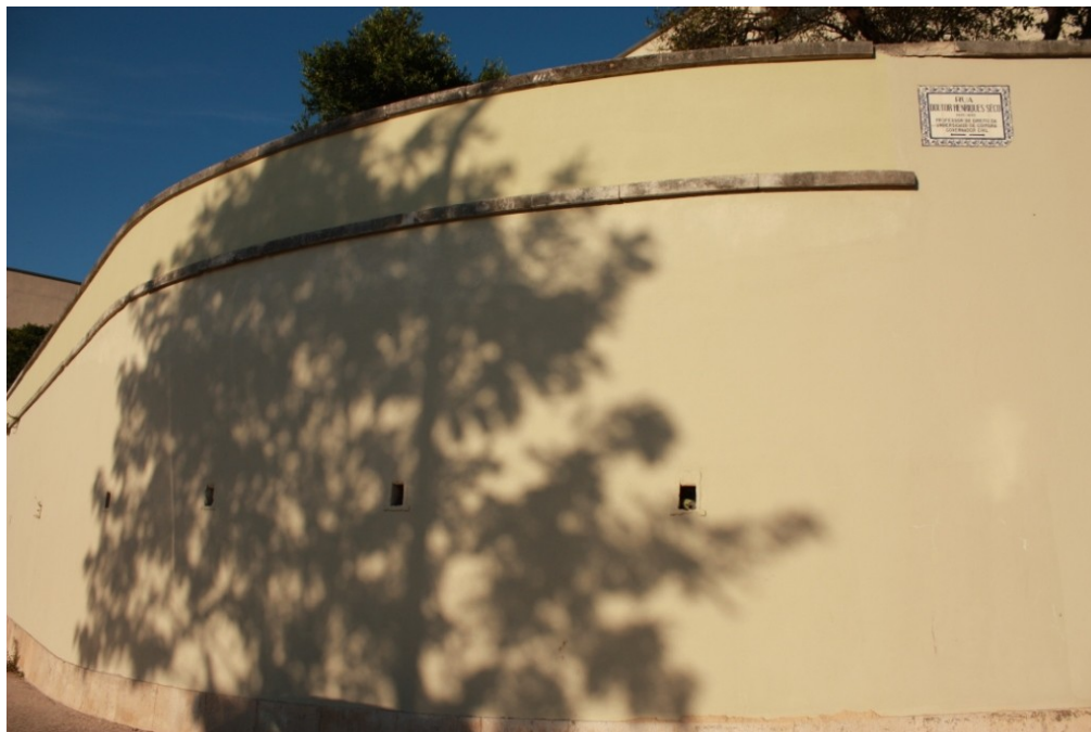
Figura 86. Muro da Escola Secundária José Falcão que ruiu. (Foto: Ana Cação)
