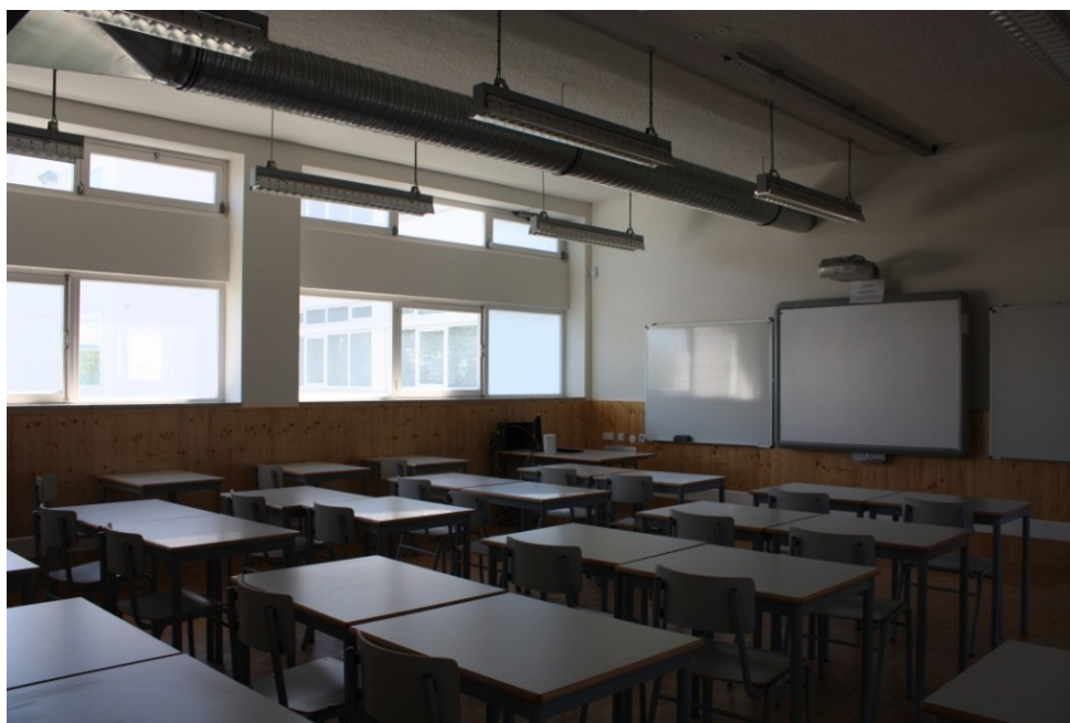
Figura 100. Escola Secundária Dr. Joaquim de Carvalho (Figueira da Foz). Tubagem à vista numa sala de aula. (Foto: Ana Cação)
