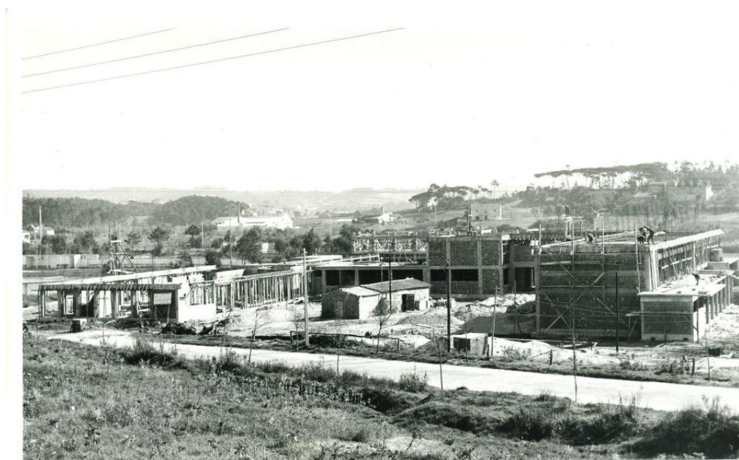
Figura 17. Alçado poente do Liceu Nacional da Figueira da Foz, em construção. (Foto: MOP/JCETS)
