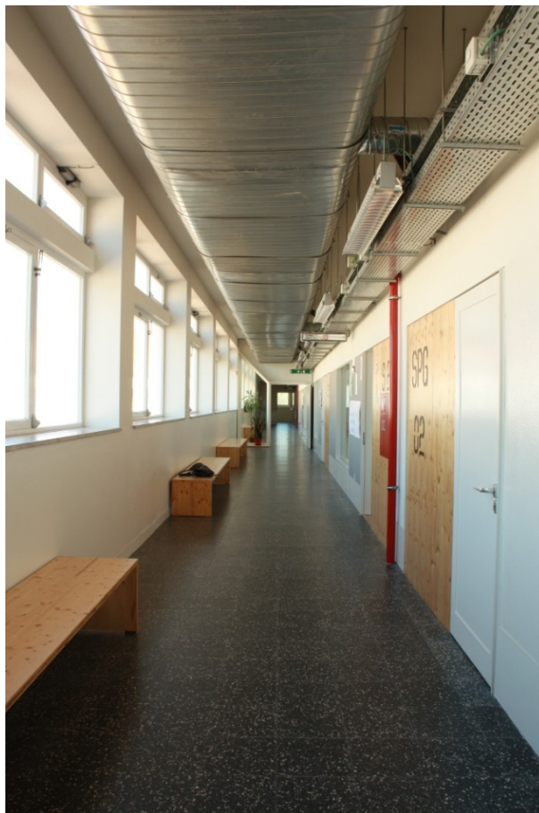
Figura 101. Escola Secundária Dr. Joaquim de Carvalho. Tubagem visível no corredor adjacente às salas de aula. (Foto: Ana Cação)
