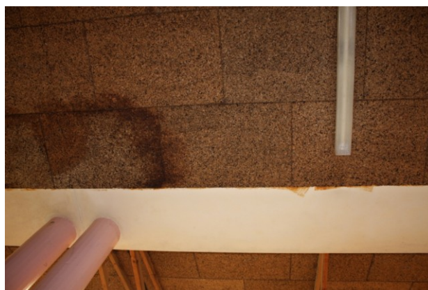
Figura 108. Escola Básica dos 2.º e 3.º Ciclos com Ensino Secundário da Guia. Infiltrações no tecto do Bloco B. (Foto: Ana Cação)
