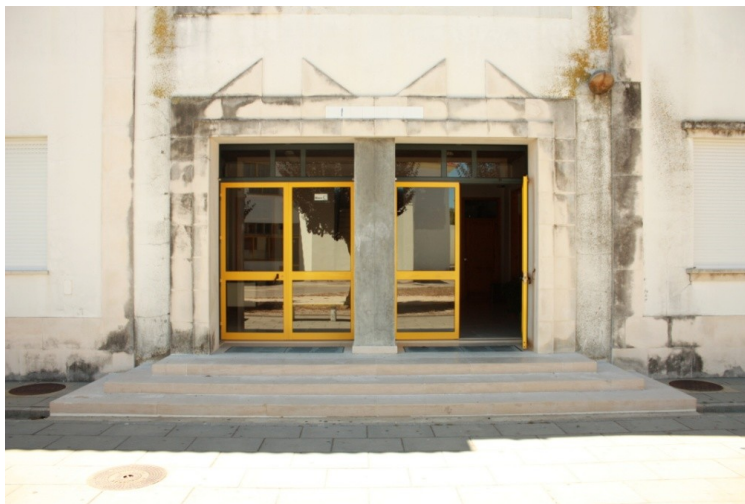
Figura 109. Escola Básica dos 2.º e 3.º Ciclos com Ensino Secundário da Guia. Colonização biológica na fachada do Bloco C. (Foto: Ana Cação)
