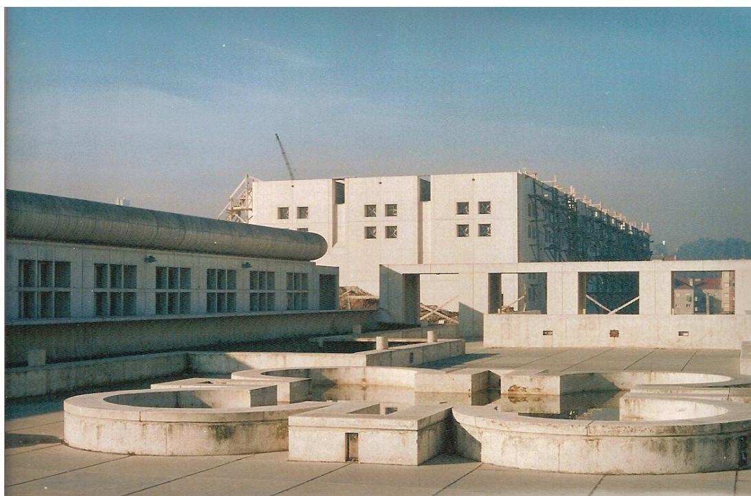
Figura 7. Escola Secundária de Benfica. Bloco em construção. (Fonte: MOP/JCETS; Foto: Arq. RHF)
