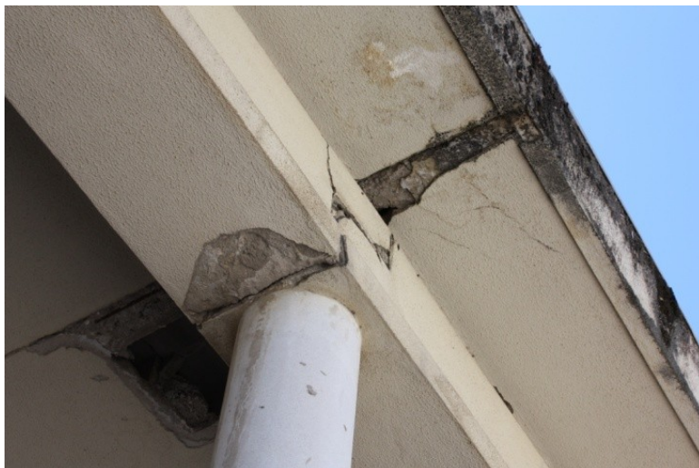
Figura 115. Escola Secundária Dr. Bernardino Machado. Danos estruturais nos pilares da fachada principal do pavilhão gimnodesportivo. (Foto: Ana Cação)
