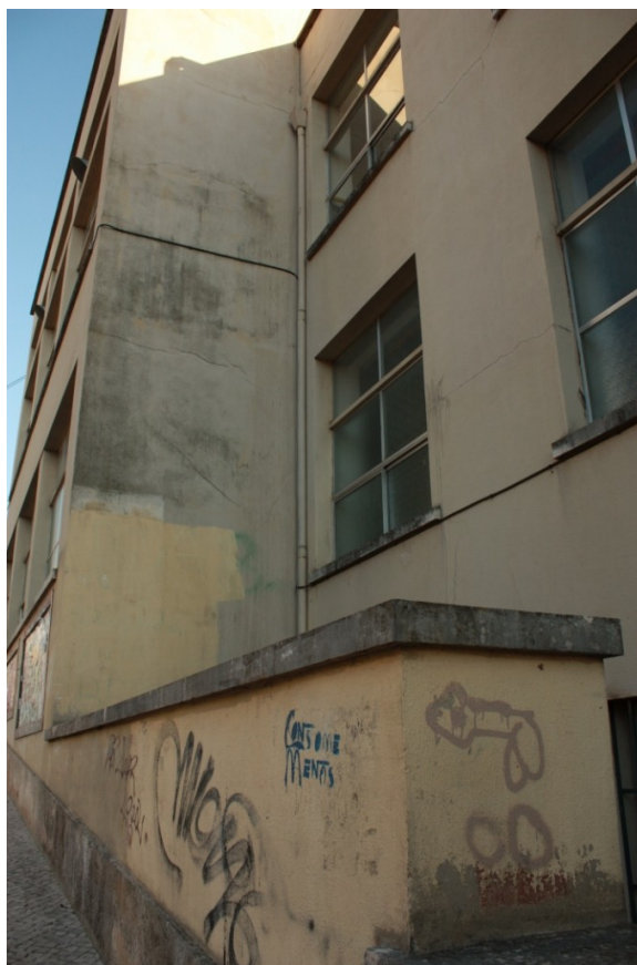
Figura 79. Escola Secundária José Falcão. Vista sobre o alçado lateral. (Foto: Ana Cação)
